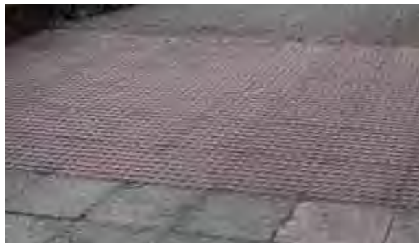
Figura 15. Características de la baldosa de botón existente.
