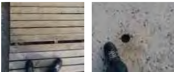
Figuras 21 y 22. Deterioro del pavimento de madera en accesos a la playa y orificios en el pavimento de hormigón de los espigones.
