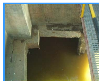
Entrada de agua bruta.
