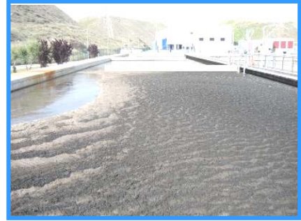
Canal de sedimentación de fangos
