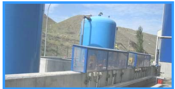
Depósitos e instalación de precipitación química.
