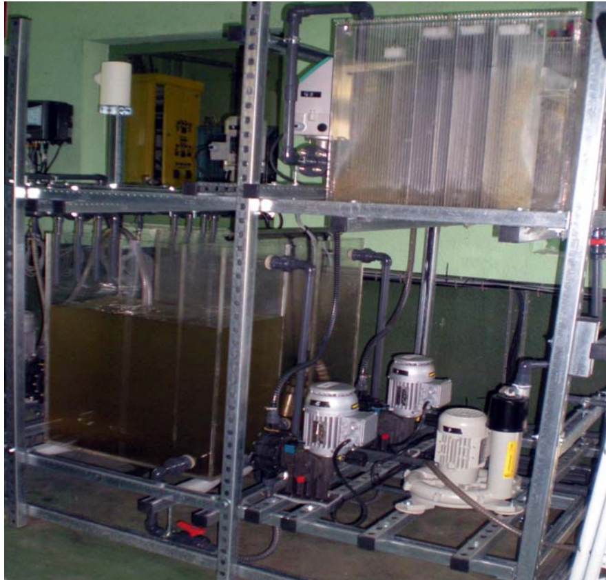
Figura 6.8. Vista de los tanques de alimentación y los electrocoaguladores
