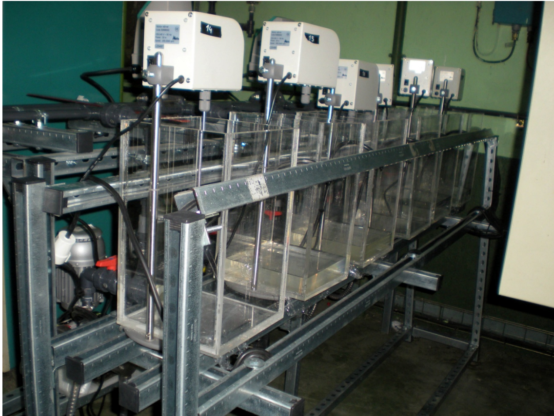
Figura 6.7. Vista parcial de la zona de dosificación
