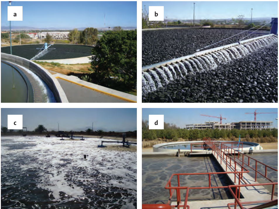
Figura 1.19. a) y b) Filtro percolador de la planta de tratamiento de aguas residuales sur, Querétaro, México, c) Laguna aireada de la planta de tratamiento de aguas residuales de Lago de Texcoco, México, d) Reactor aerobio de la planta de tratamiento de aguas residuales de Metepec, México.
