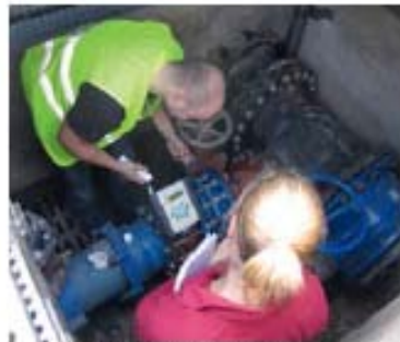
Energieaudit an einem Brunnenfeld Well field energy audit
