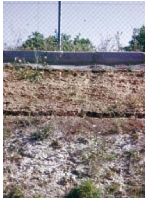
Foto 4.2 El incorrecto diseño de los taludes en los muros de separación entre balsas, puede hacer que la erosión debida a la oscilación continua del nivel del agua, arrastre el material fino al fondo de la balsa acelerando el proceso de colmatación.
