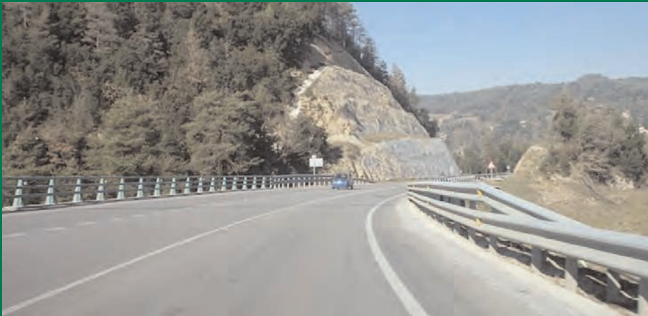
Desmunts molt verticals que generen una gran discontinuïtat transversal.
