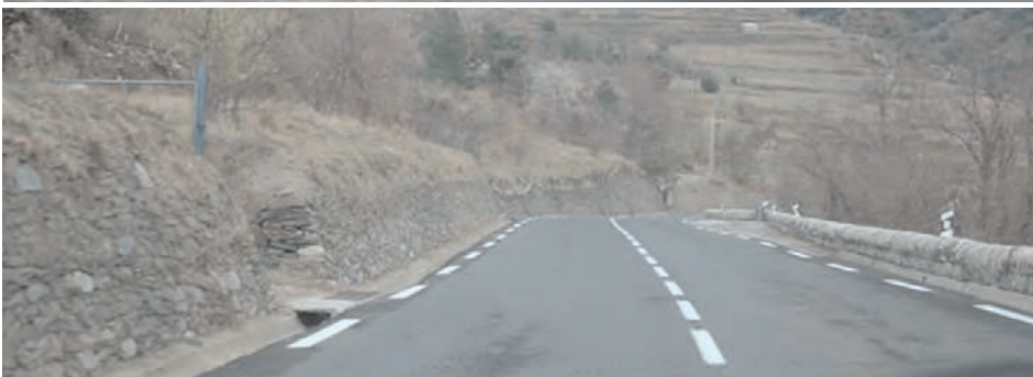
1 i 2. Tractament del peu del talús amb gabions d'escullera durant l'execució i en la primera fase de creixement. 3 i 4. Tractament del peu del talús amb mur de pedra.
