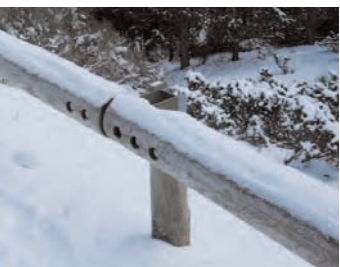
1. Barrera de fusta homologada, no reconeguda a les recomanacions de sistemes de contenció. Ofereix el mateix nivell de contenció que una barrera metàl·lica simple.
