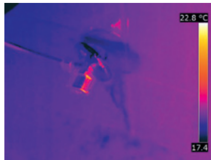
Imagen 14. Fugas en la instalación. Lo que no se detecta a simple vista se puede detectar con la cámara infrarroja: se aprecian restos de humedad, comprobándose posteriormente al retirar el embellecedor cómo fuga la rosca de la llave de cierre.
