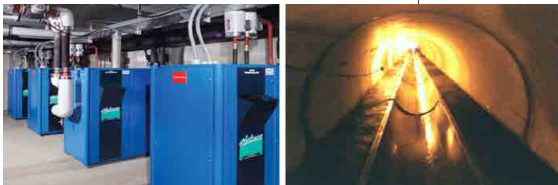
Figura 10. Bombas de calor en una instalación de intercambio con aguas residuales. Intercambiador, de 200 m de longitud, de la instalación de Zurich-Wipkingen. Fuente: ENERES/KASAG.
