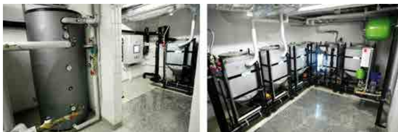
Figura 8. Instalación de recuperación y tratamiento de aguas grises Pontos AquaCycle combinada con el modulo de recuperación de energía Pontos HeatCycle en la residencia de estudiantes OIKOS en Friburgo, Alemania.
