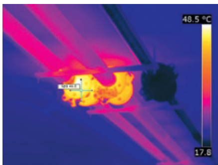
Imagen 12. En la distribución de agua a las viviendas llama la atención que se hayan colocado también dilatadores.
