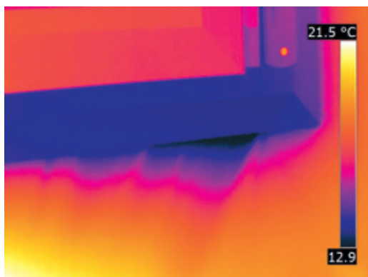
Imagen 4. Infiltración de aire exterior por el marco de una ventana. Se ven la diferencia de patrones térmicos entre el agua y el aire claramente.
