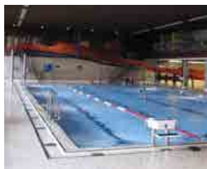
Figura 22. Binningen: escuelas, la administración y piscina comunitaria. Se calientan las aguas residuales. Fuente: ENERES/KASAG.
