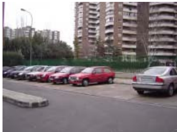
Zona de aparcamiento sin marcas viales.
