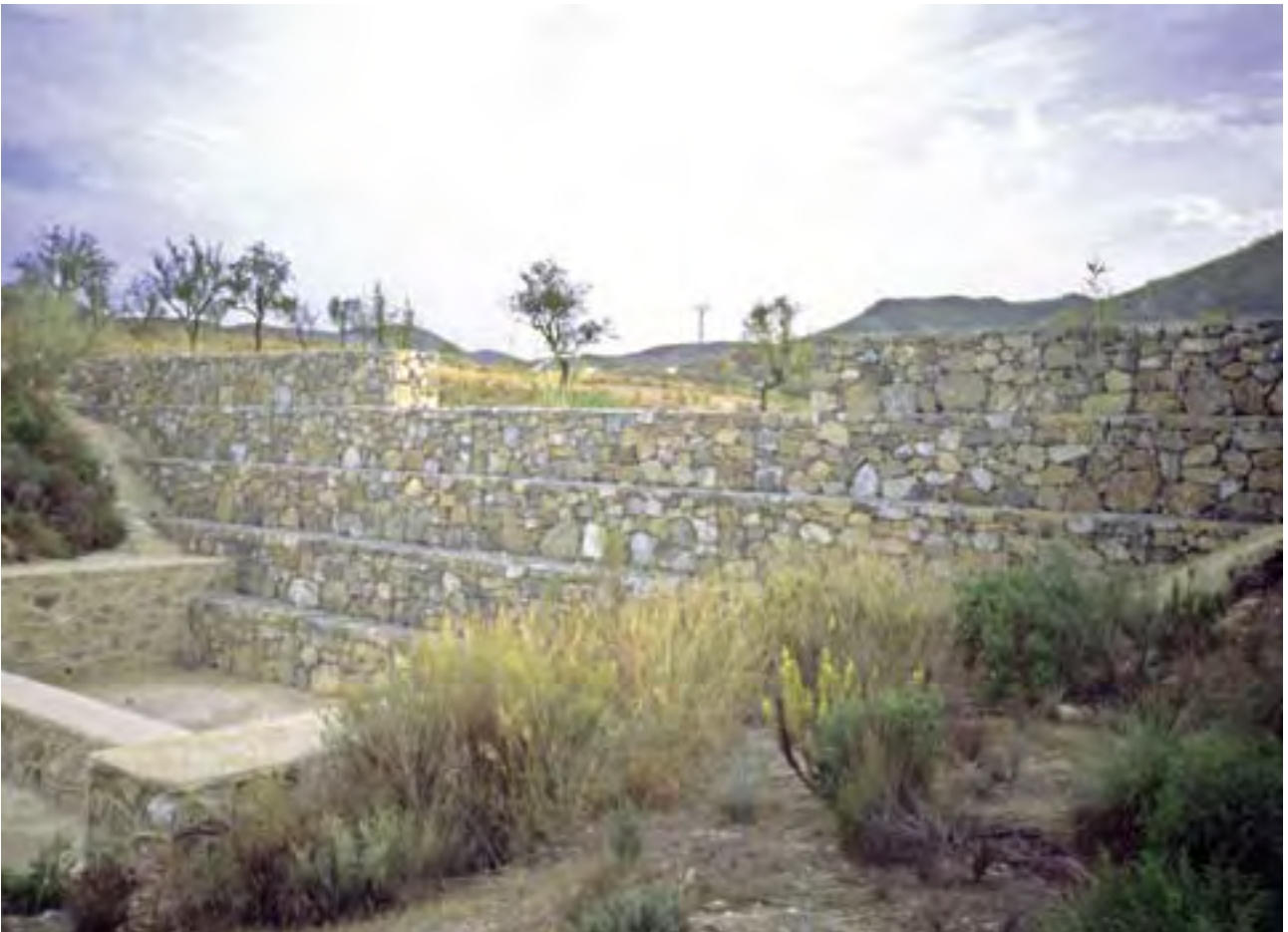
Dique de retención de sólidos.
