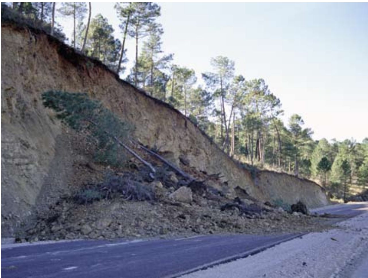
Pequeño desprendimiento originado por la desestabilización de un talud tras la construcción de una carretera.
