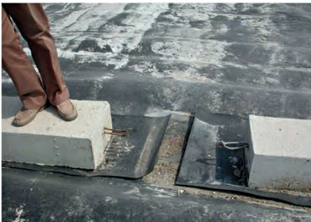
Figuras 7.4.22.3.▶ Deslizamiento de lastres de hormigón articulados por oxidación del cable de unión
