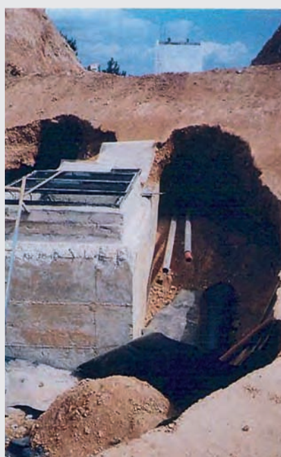
▲ Figura 7.4.2.5. Detalle de la tubificación, junto a la arqueta de toma.
