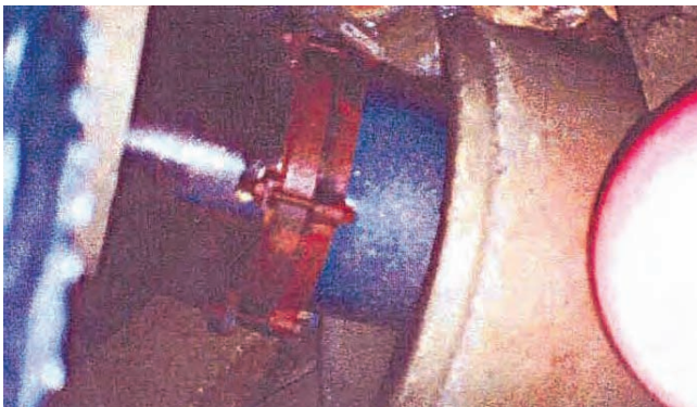
◀ Figura 7.4.4.2 Vista de la falta de protección peligrosa en la toma de fondo
