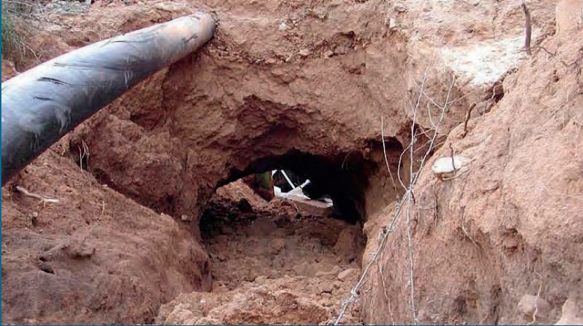
▲ Figura 7.4.5.5. Vista desde el talud exterior. Tubificación en la zona del desagüe de fondo, con tubería de PEAD. Obsérvese en la parte izquierda, la nada recomendable práctica de emplazar la conducción de llenado por el terraplén y, en este caso, por la zona del desagüe de fondo
