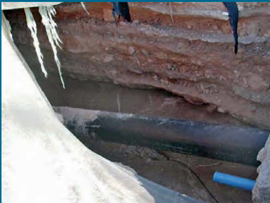
▲ Figura 7.4.5.3. Vista de la rotura desde el talud interior
