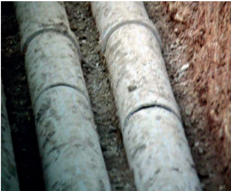
▲ Figura 7.4.16.1. Vista de la rotura por flexión en las conducciones de salida de fibrocemento
