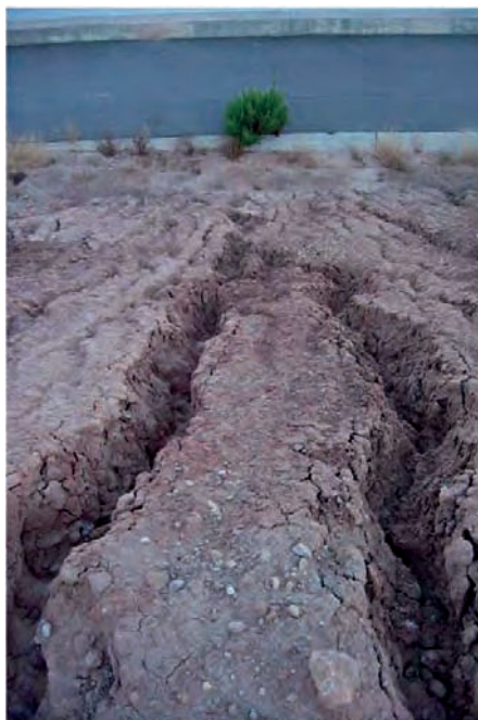
▲ Figura 7.4.23.2. Formación de cárcavas en talud en desmonte
