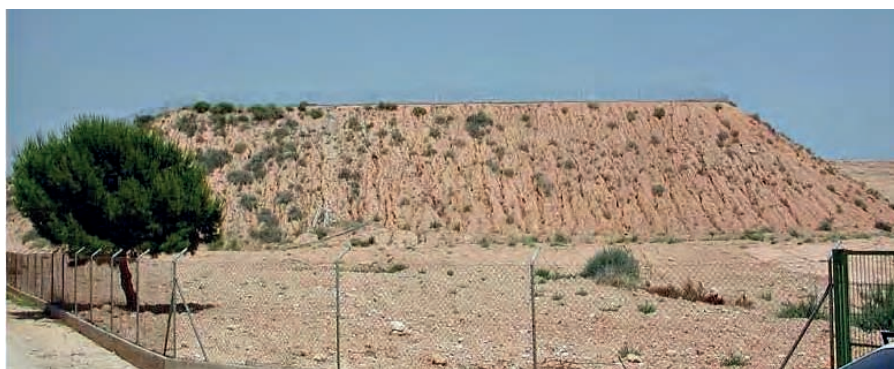
▲ Figura 7.4.23.3. Formación de cárcavas en talud exterior (vista general)
