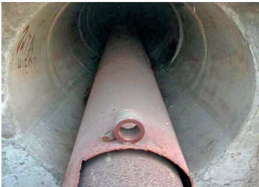
▲ Figura 7.4.14.1. Situación actual de la conducción de 300 mm en el interior de la de 400 mm
