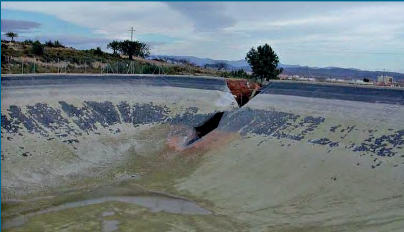
▲ Figura 7.4.5.6. Vista de la rotura de la fotografía anterior, desde el talud interior
