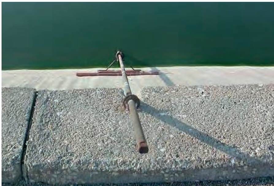
▲ Figura 7.4.14.2. Extremo del eje de maniobra de la compuerta interior colocada después del incidente
