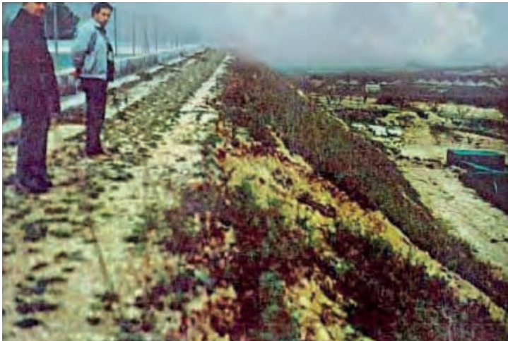
▲ Figura 7.4.17.1. Zona de afección del deslizamiento superficial
