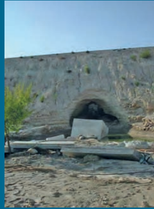
▲ Figura 7.4.5.2. Vista de la rotura anterior, desde el talud exterior
