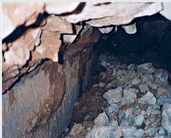
▲ Figura 7.4.2.3. Detalle de la vía creada por el agua junto al paramento de la galería en presión.
