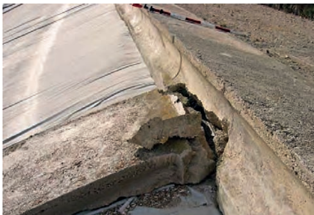
Figura 7.4.22.2.▶ Arranque por desplazamiento hacia el interior del vaso, del lastre antisucción eólica, por anclaje deficiente.
