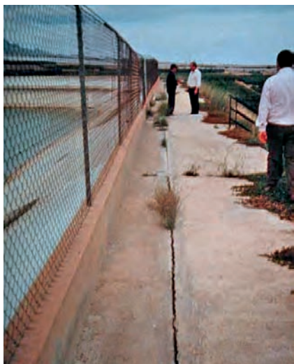
◀ Figura 7.4.21.2. Grieta surgida entre el zuncho de anclaje de la lámina y un pavimento de hormigón en coronación
