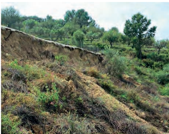
◀ Figura 7.4.18.1. Deslizamiento superficial de la capa externa del terraplén tras lluvias intensas
