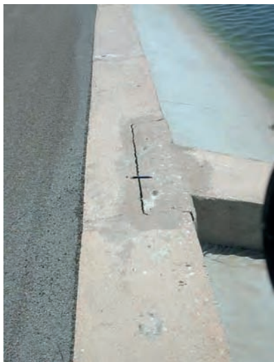
◀ Figura 7.4.22.1. Grieta por desplazamiento hacia el interior del vaso del lastre antisucción eólica, por anclaje deficiente.
