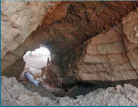
▲ Figura 7.4.5.1. Tubificación en el desagüe de fondo con tubería de PEAD de 700 mm
