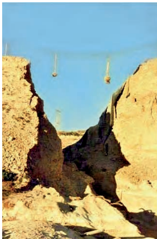
▲ Figura 7.4.3.1. Rotura del desagüe de fondo
