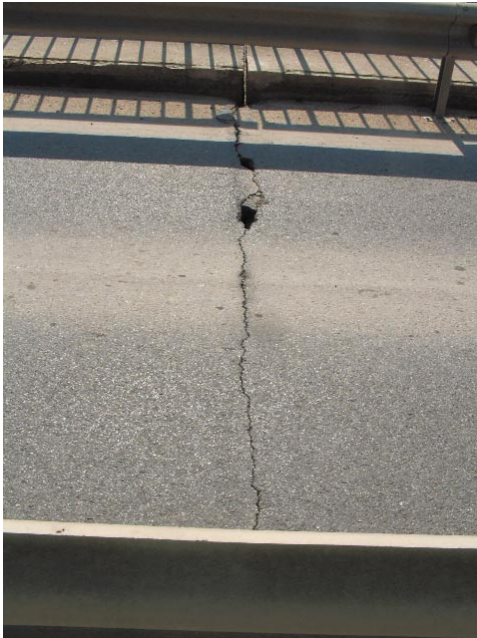
Fig. 5.1. Falta de junta
