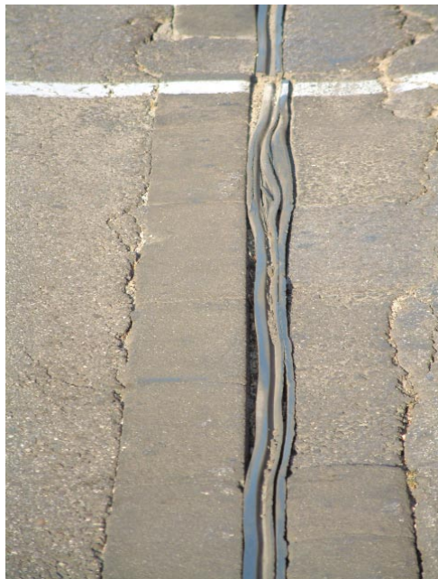
Fig. 5.9. Deterioro en junta de perfil de caucho comprimido.
