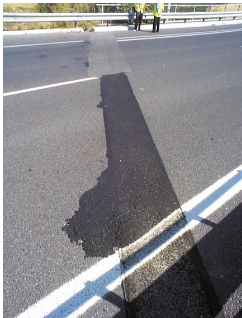
Fig. 5.11. Deterioro junta de betún modificado por mala ejecución y subsiguiente arrastre.
