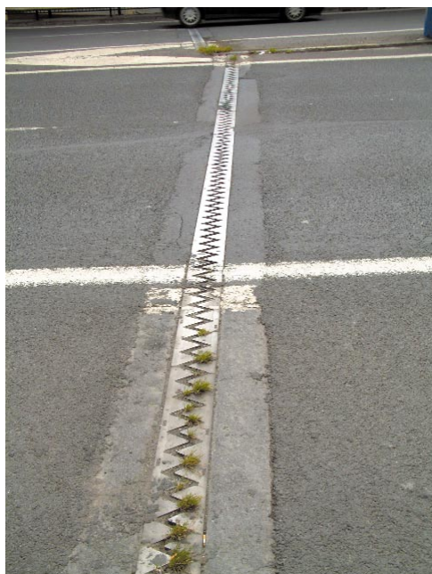
Fig. 5.4. Aterramiento de la junta de peine que impide su movimiento de cierre.
