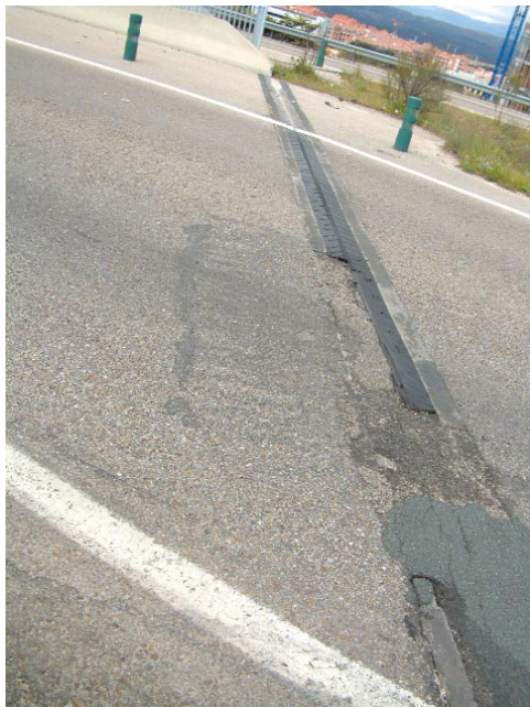
Fig. 5.10. Reparación incorrecta por repavimentación en zona de elementos perdidos.
