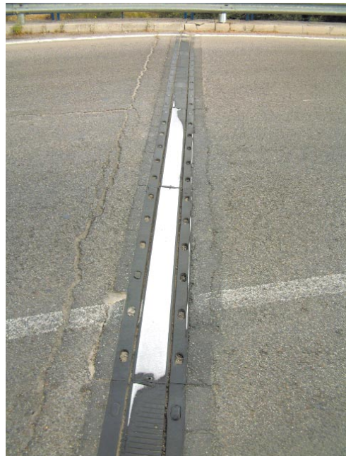
Fig. 5.8. Deterioro de junta de perfil de elastómero armado por envejecimiento.
