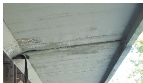
Fig. 5.12. Rotura y hundimiento de junta en voladizo de tablero.
