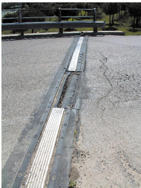
Fig. 5. Falta de mantenimiento.
