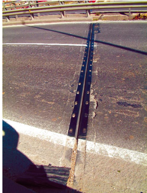
Fig. 5.2. Falta de limpieza y aterramiento de la junta
