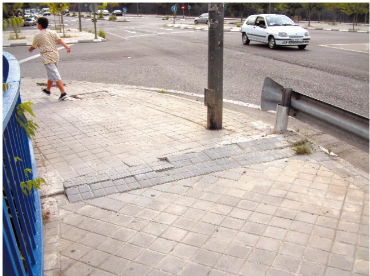
Fig. 5.3. Falta de junta en aceras.
