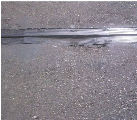
Fig. 5.7. Hundimiento elemento de junta por instalación inadecuada.
