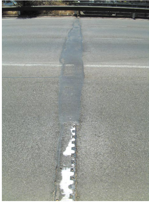
Fig. 5.6. Deterioro de junta por repavimentación sobre la misma.
