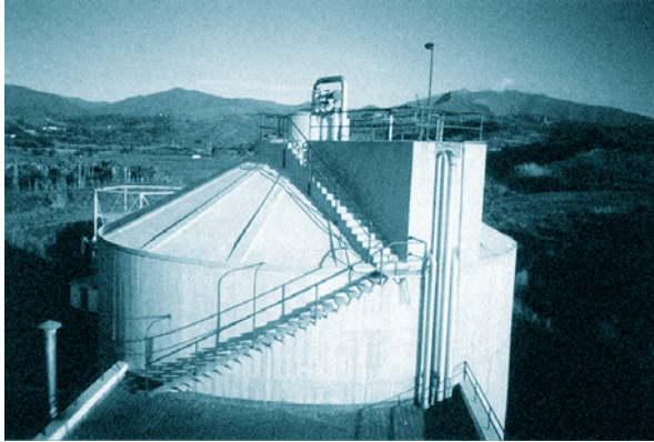
FOTOGRAFÍA 20. Digestor anaerobio para la estabilización de los lodos.
