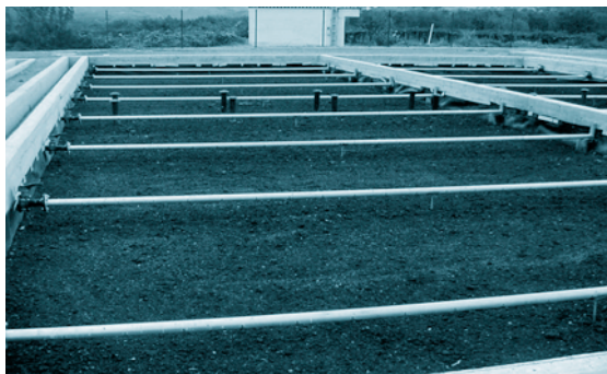
FOTOGRAFÍA 11. Sistema de reparto de las aguas a tratar.
