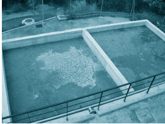
FOTOGRAFÍA 24. Eras de secado de lodos.
