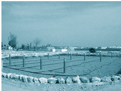
FOTOGRAFÍA 17. Tuberías para el reparto de la alimentación en un HAFSs vertical (PECC)
