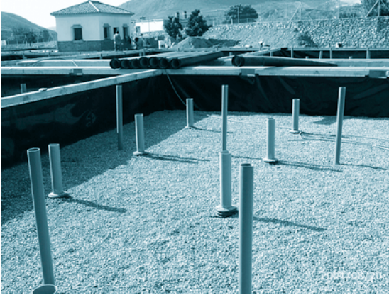
FOTOGRAFÍA 7. Chimeneas de ventilación del sustrato filtrante.
