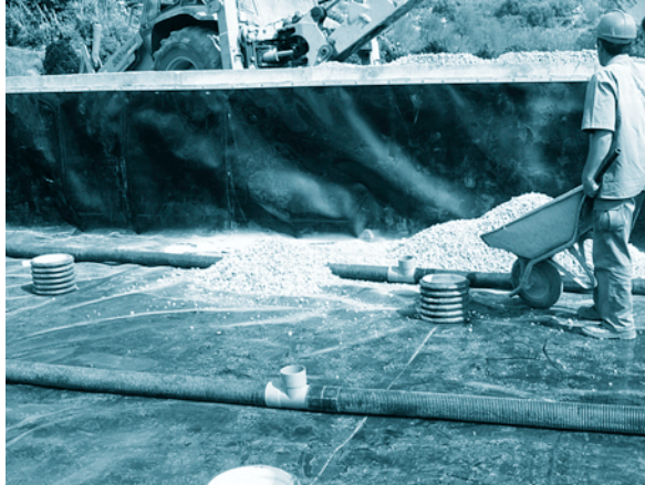
FOTOGRAFÍA 6. Tuberías de drenaje en la solera de los filtros de turba.
