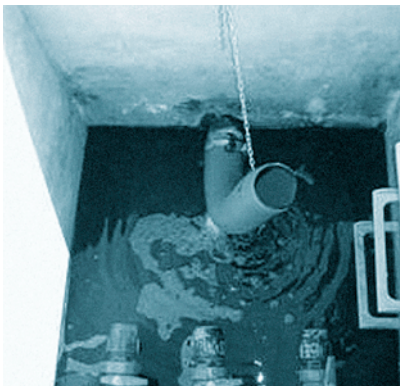
FOTOGRAFÍA 9. Tubería de evacuación de efluentes, conectada a las tuberías de drenaje. Al ser flexible permite controlar el nivel del agua en el sustrato filtrante.
