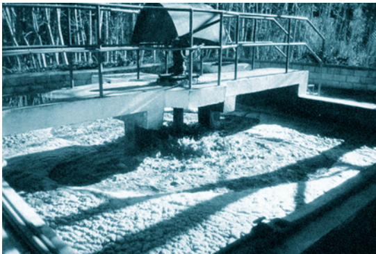
FOTOGRAFÍA 14. Cuba biológica con aireador mecánico superficial.
