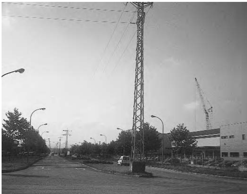
Poste eléctrico sin proteger
