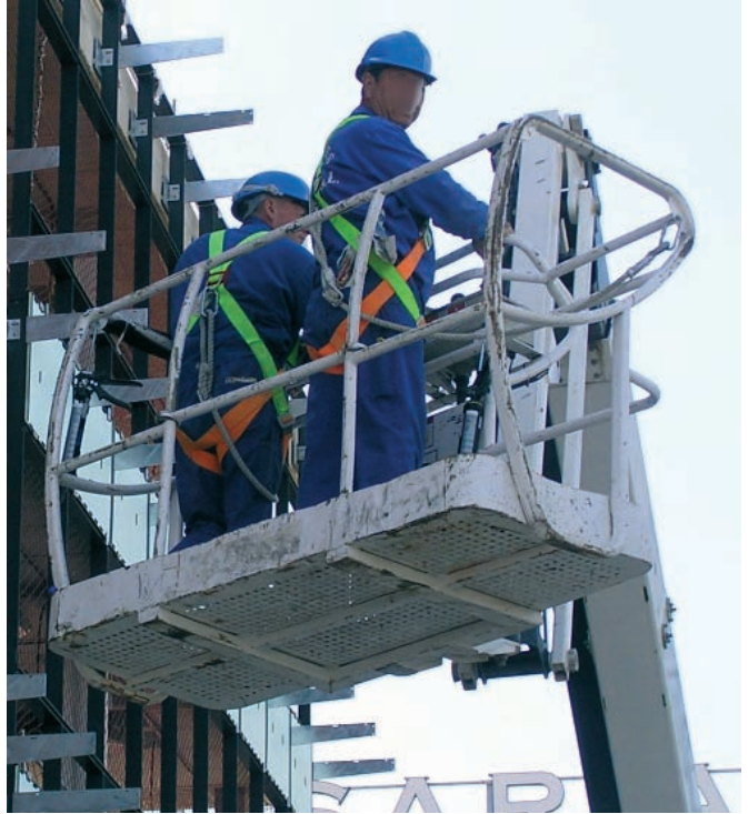
Figura 82. Trabajador con arnés en plataforma
