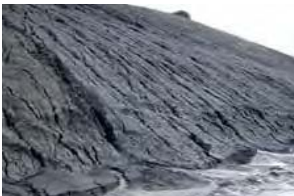
Figura 7. Grandes procesos erosivos tras una lluvia intensa en la Autopista de la Costa del Sol (Málaga) (Foto: Fernando Valladares).
