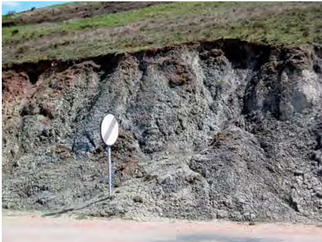
Figura 2. Flujos de barro ( mudflows ) en un pequeño desmonte de una carretera local. Los procesos geomorfológicos que se desarrollan en estos desmontes son similares a los que operan en otros ambientes continentales (por ejemplo, zonas de montaña), pero tienen mucho menor tamaño (Foto: J.F. Martín Duque).
