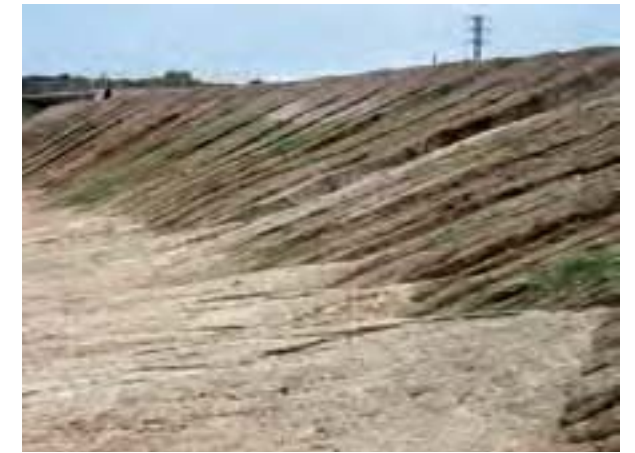
Figura 15. Erosión hídrica muy severa en terraplenes de una autovía. La paralización de las obras impidió el extendido de tierra vegetal y la revegetación durante un largo período de tiempo (Foto: J.F. Martín Duque).
