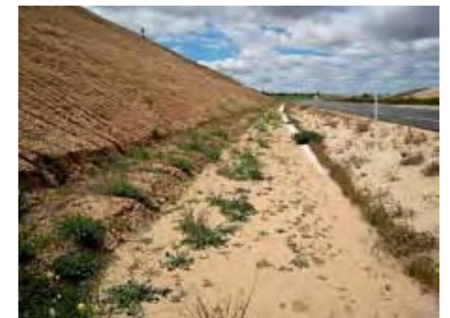
Figura 8. Acumulación de sedimentos procedentes de un desmorte, que prácticamente colmata una cuneta (Foto: J.F. Martín Duque).
