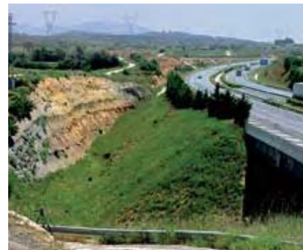
Figura 8. Diferencias en la densidad de cobertura vegetal alcanzada en un desmonte (izquierda) y un terraplén (derecha) próximos a la Autovía A-3 (Requena, Valencia). Las diferencias se deben principalmente a la orientación (norte en este caso concreto) y condiciones del suelo más favorables para el establecimiento de las plantas en el terraplén. El establecimiento de las plantas en el desmonte orientado hacia el sur es prácticamente nulo (Foto: Esther Bochet).
