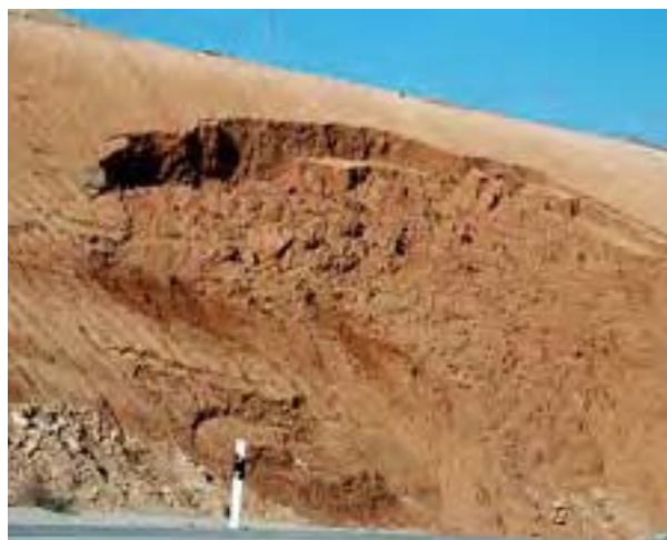
Figura 5. Ejemplo de seepage erosion en un desmorte construido sobre materiales arenosos (Foto: J. Vázquez).
