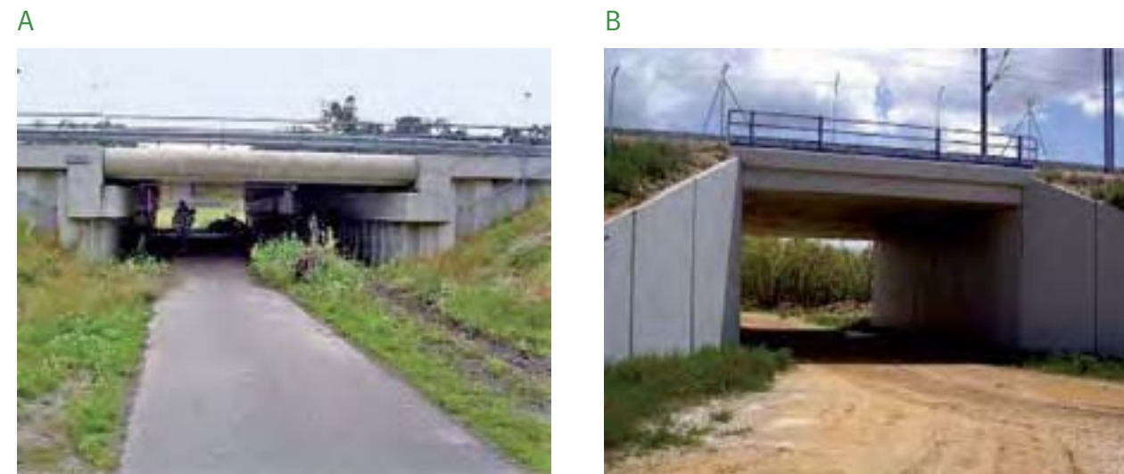
Figura 7. Pasos inferiores multifuncionales con adaptaciones para favorecer su uso por la fauna: con áreas revegetadas a ambos lados del camino en una autovía holandesa (A) y un paso con solado de tierra ubicado en un tramo de la provincia de Guadalajara del TAV Madrid-Barcelona (B).
