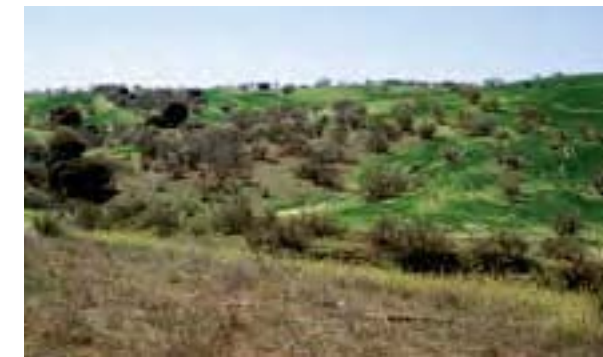
Figura 2. Terraplén con orientación sur de la autopista A-5 en la provincia de Madrid, en la localidad de Arroyomolinos. En la foto se observa en primer término el talud objeto de estudio y en segundo la cercanía a una mancha de vegetación natural consistente en una dehesa de Retama sphaerocarpa (Foto: Pablo García-Palacios).
