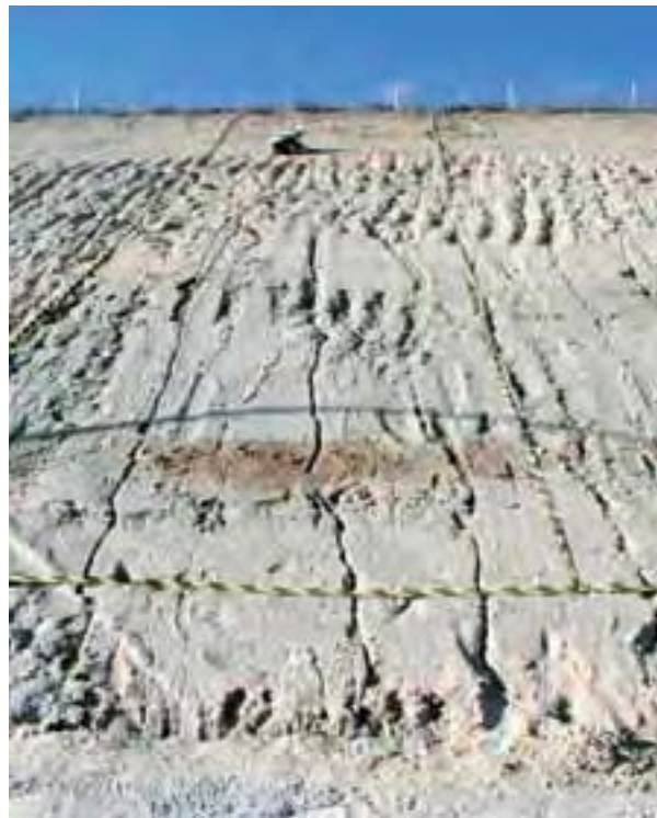
Figura 2. Aspecto de los taludes de un desmonte de la autovía M-12 días antes de proceder a su hidrosiembra. Se observan los canales generados por los dientes de los cazos de las retroexcavadoras que han sido ampliados por erosión, generando regueros y pequeños desprendimientos (Foto: Ignacio Mola).
