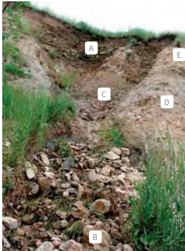
Figura 4. Cabecera de deslizamiento (A) y derrubios movilizados (B) en un desmorte de carretera, a favor de una surgencia de agua (C) producida en el contacto entre una roca impermeable (D) y unos cantos y bloques permeables (E), correspondientes a un depósito de abanico aluvial (Foto: J.F. Martín Duque).
