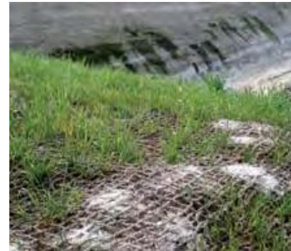
Figura 3. Red orgánica de fibra de coco instalada un tramo de AVE en Humilladero (Málaga). Obsérvese cómo la manta permite la germinación de las especies herbáceas.
