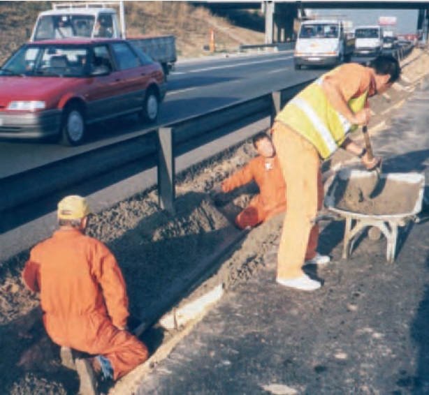
Figura 35. Hormigonado manual de cuneta. Trabajando sin equipo de protección individual.
