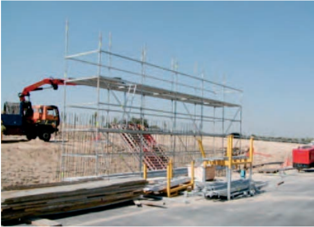
Figura 59. Andamio tubular homologado, montado para la realización del ferrallado, encofrado y hormigonado de un muro.
