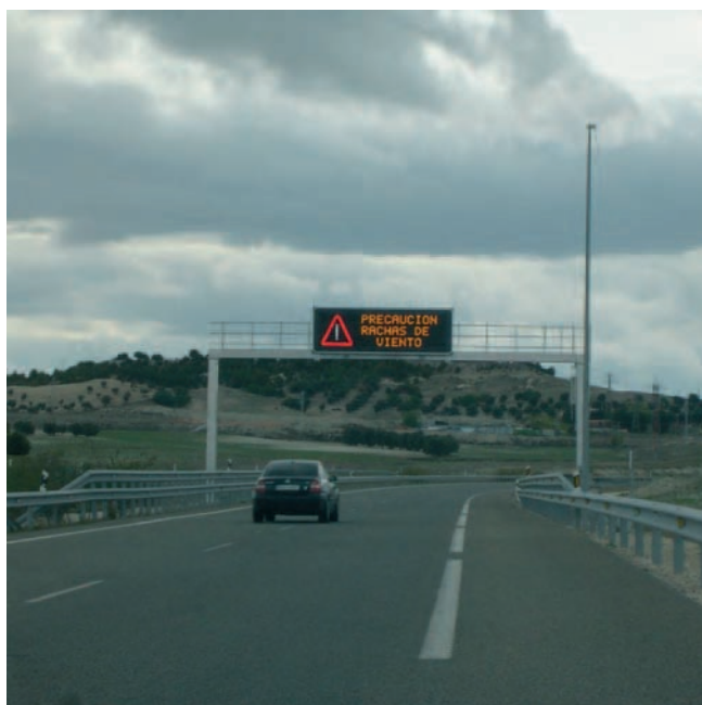
Figura 41. Detalle de PIV (Panel de Información Variable), con estructura normal, es decir pasa de lado a lado de la calzada.
