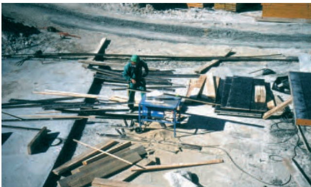
Figura 58. Falta de orden y limpieza alrededor de la sierra de corte.
