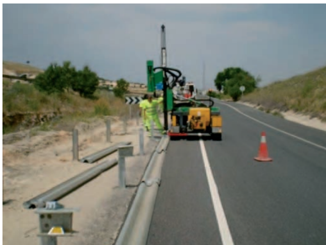
Figura 19. Máquina bincapostes trabajando con riesgo.
