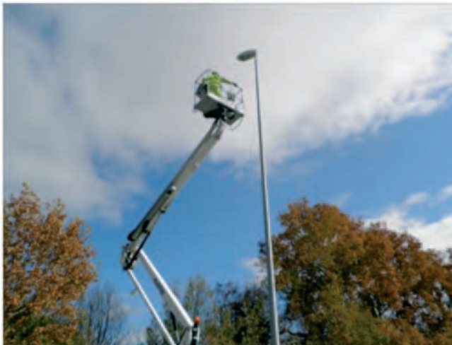
Figura 53. Limpieza de luminaria desde PEM.
