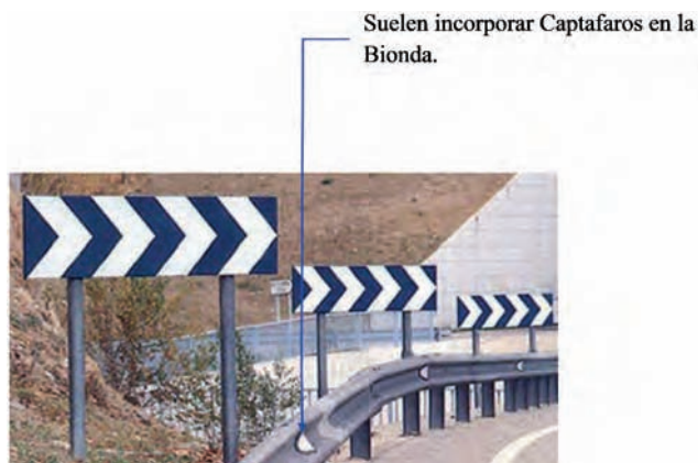
Figura 28. Detalle de paneles direccionales en una zona de curva. Se observa la colocación de captafaros en la bionda.
