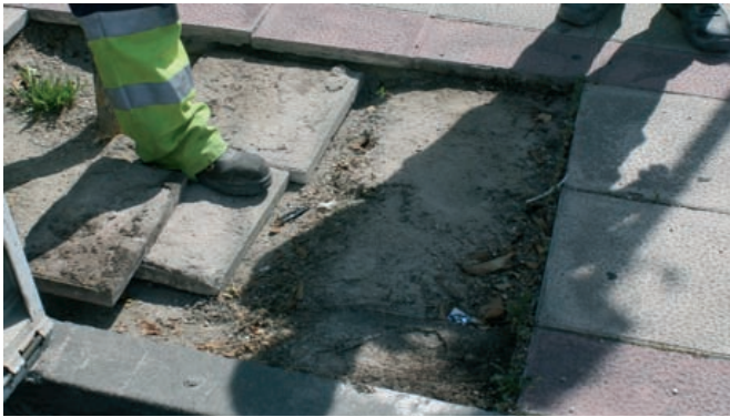
Figura 173. Baldosas sueltas por el paso del tiempo y fallo del mortero.
