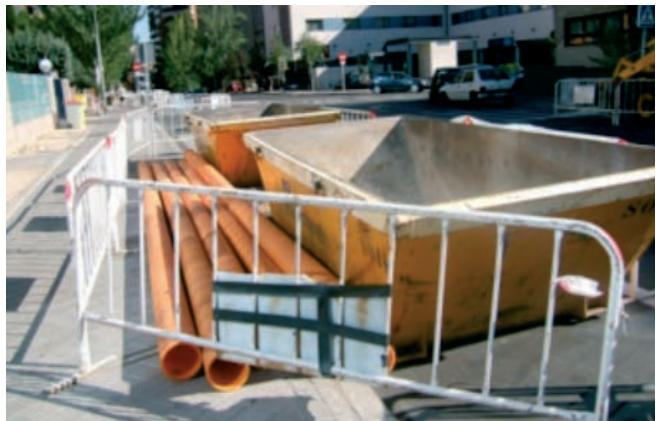
Figura 020. Contenedores y tuberías.
