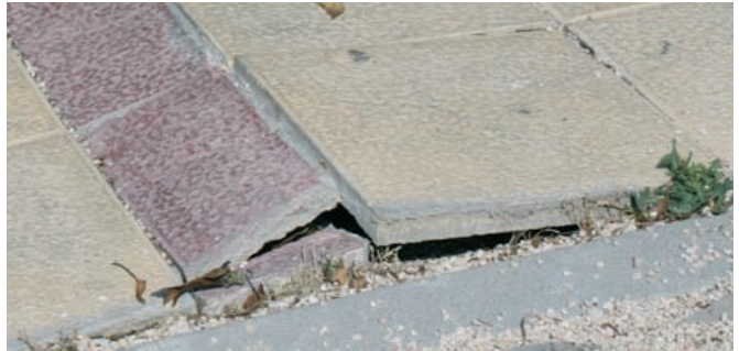
Figura 171. Levantamiento de baldosas, provocado por la dilatación de las mismas.
