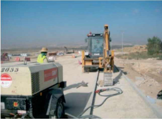
Figura 054. Ejemplo de como el trabajador se mantiene fuera del máximo alcance de la máquina.
