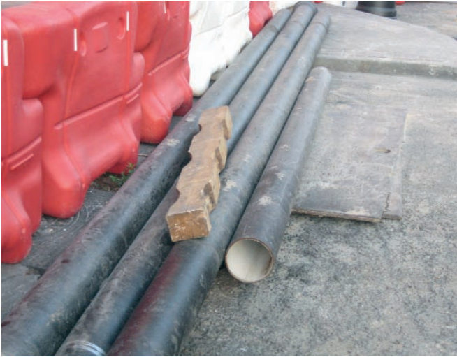
Figura 112. Emplear piezas facilitadas por el suministrador que permiten mantener los tubos en posición estable.
