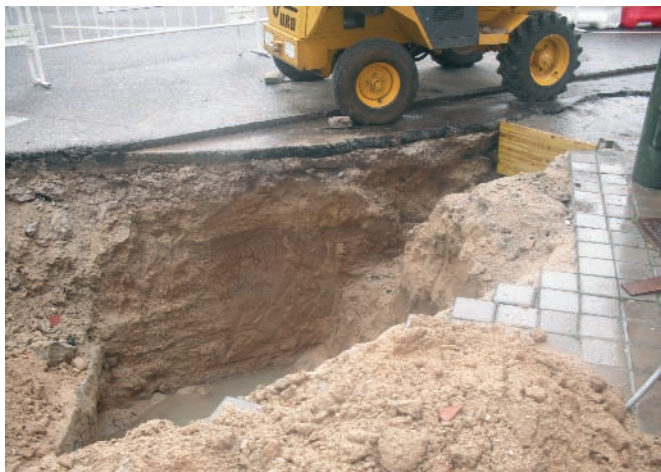
Figura 090. Acopio de tierras en el borde de la zanja, provocando una sobrecarga por su peso propio más el acumulado por el agua de la lluvia. Enfrente paso de vehículos provocando una carga dinámica.
