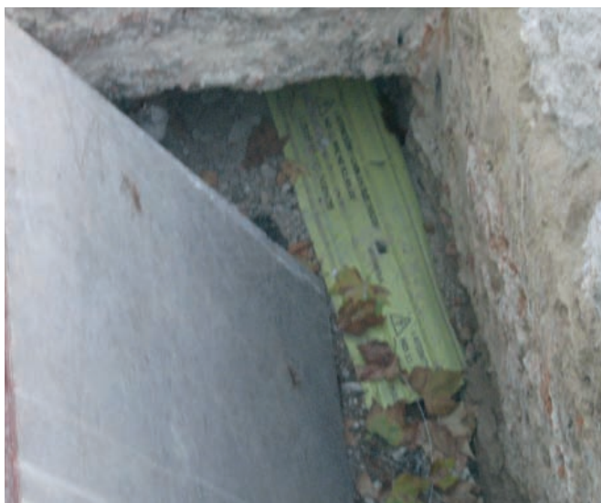
Figura 119. Cables protegidos con placas cubrecables
