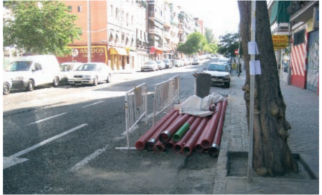
Figura 006. Acopio de material en la vía pública sin estar adecuadamente acotado.
