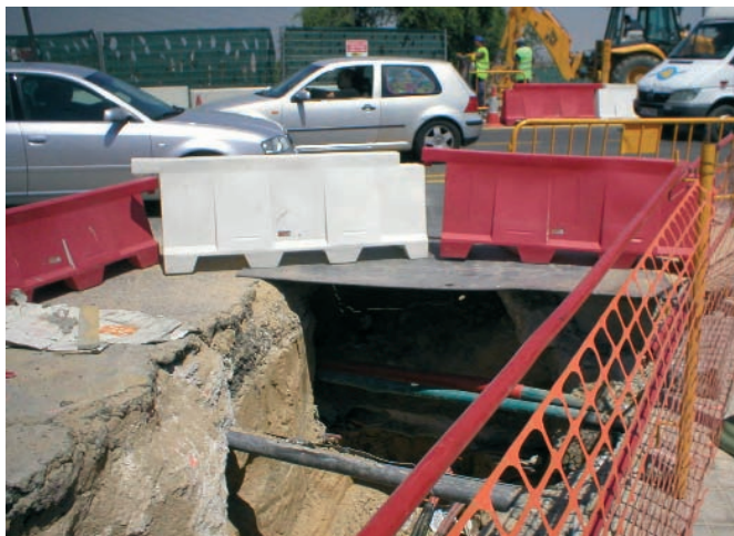
Figura 143. Apoyo comprometido en zona con intenso tráfico que podría provocar su deslizamiento.
