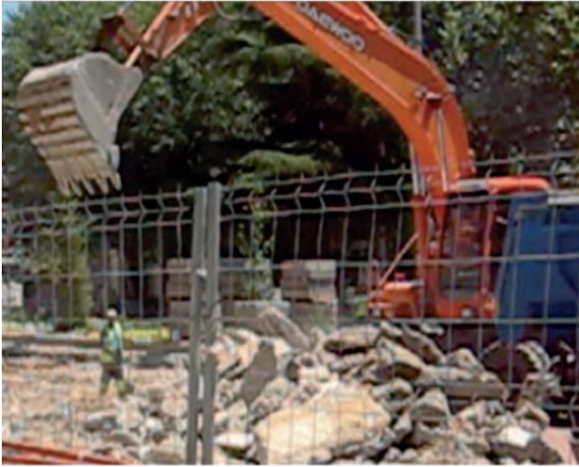
Figura 050. El operario mantiene inicialmente la distancia; pero cuando el maquinista inicia la descarga se introduce en la zona de excavación sin conocerlo el maquinista.
