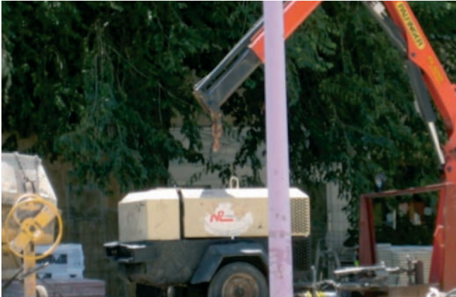
Figura 022. Descarga de un compresor.
