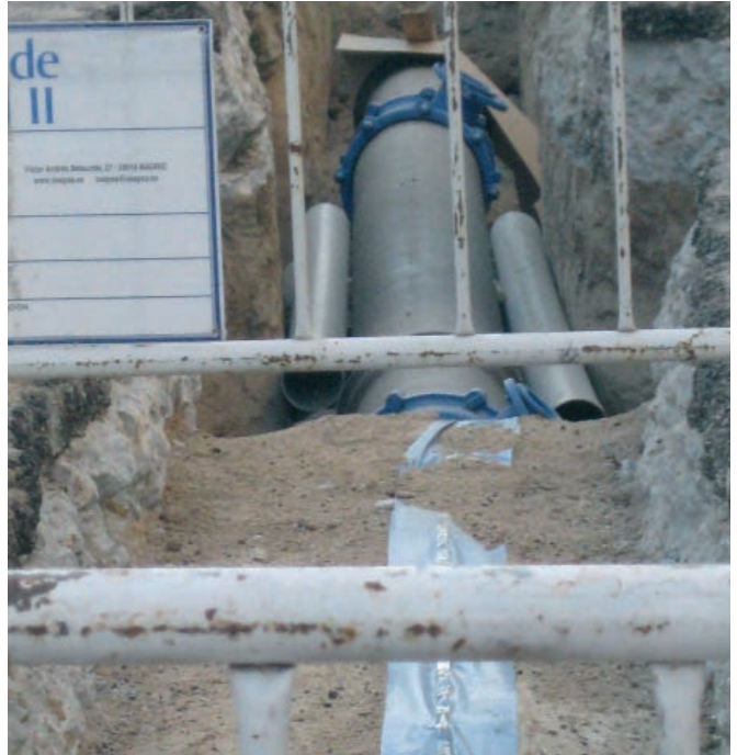
Figura 132. Ejemplo de señalización. Banda azul sobre tubería de agua.
