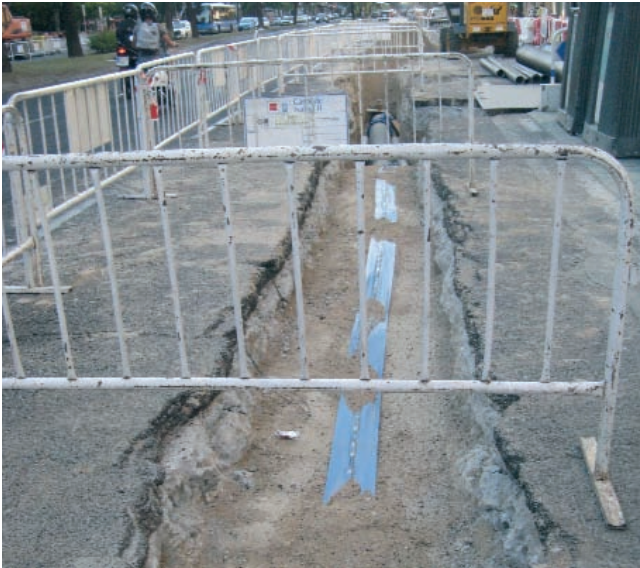
Figura 035. Canalización de abastecimiento de agua. Protegida y señalizada con una banda de polipropileno azul.
