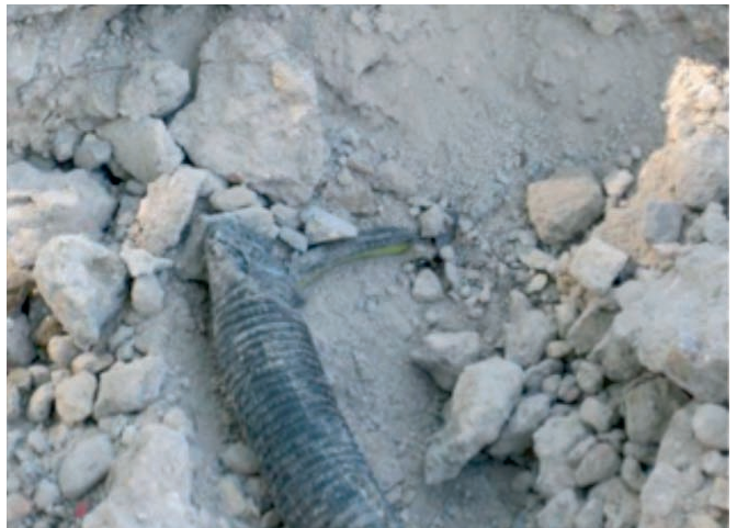
Figura 072. Rotura de protectores de canalizaciones por no utilizar equipos adecuados.
