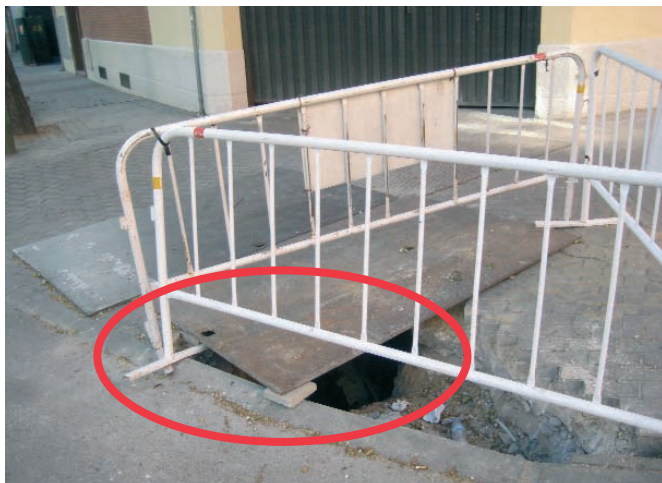
Figura 144. Apoyo inestable de la chapa.
