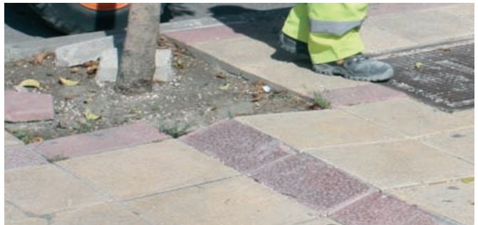
Figura 172. Levantamiento de baldosas, provocado por las raíces de los árboles.
