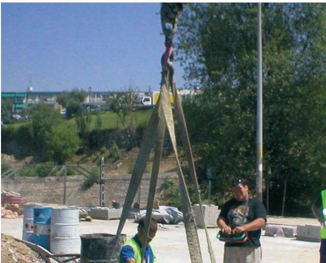
Figura 163. Eslinga retorcida bajo tensión. El trabajador que guía las cargas puede sufrir la caída de las cargas si se revuelve la eslinga.
