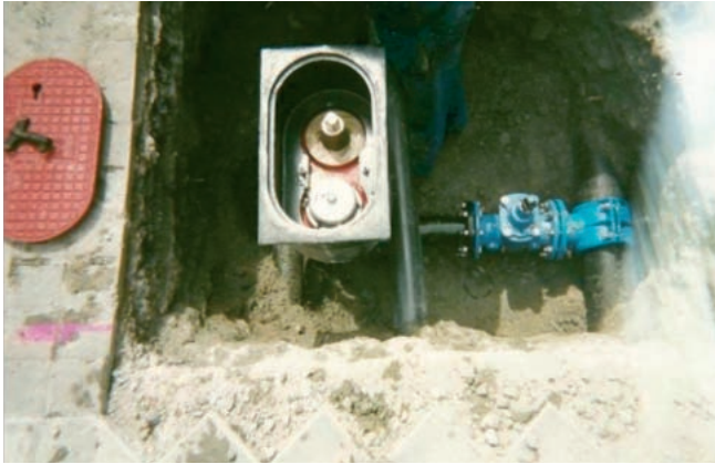
Figura 037. Hidrante para uso de bomberos.
