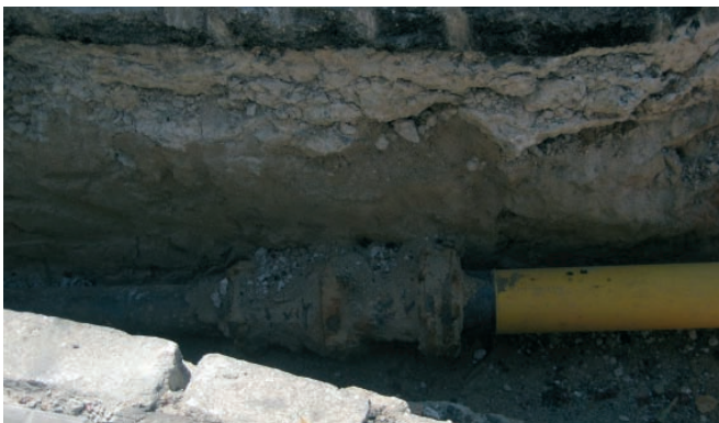
Figura 079. Reparación de conducción antigua de gas con tubo moderno de color amarillo.
