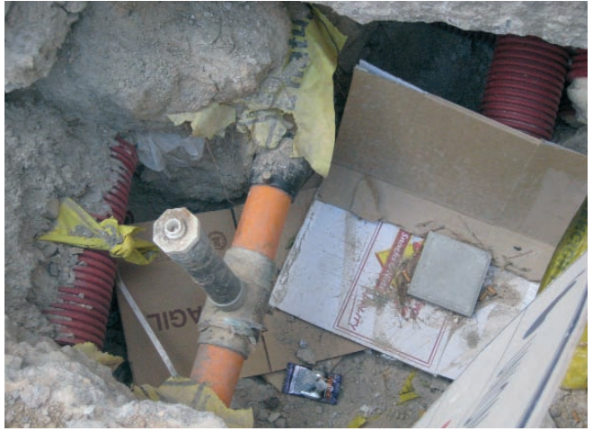
Figura 033. Acometida de gas. Obsérvese el color naranja de la conducción.
