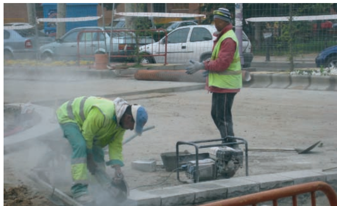
Figura 168. Polvo y proyección de partículas generadas por el corte con equipos mecánicos. Requieren el uso de protección ocular y mascarilla autofiltrante.
