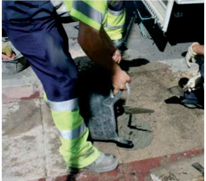
Figura 182. Vertido de mortero sin guantes de protección.
