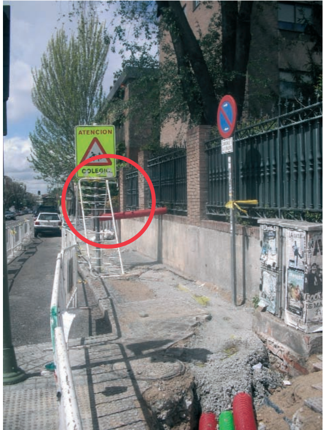
Figura 027. Sujeción improvisada de señalización.
