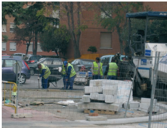
Figura 160. Operaciones de asfaltado. Vertido y extendido a mano en zona de difícil acceso para la extendidora.
