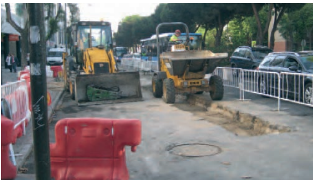
Figura 060. Circulación de maquinaria por zona inadecuada, con posibilidad de vuelco y sin utilizar cinturón de seguridad.
