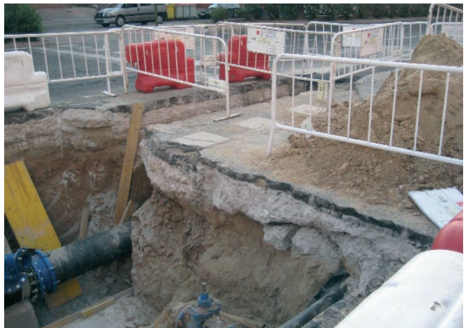
Figura 084. Acopio en borde de excavación, provocando una sobrecarga estática.
