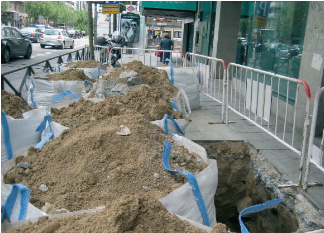
Figura 085. Productos de la excavación retirados en bolsas big-bag, pero colocados al borde de la zanja provocando una sobrecarga estática.
