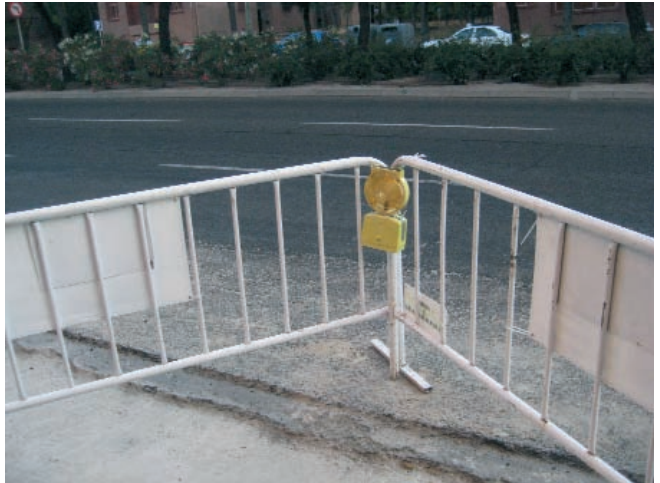
Figura 014. Luz ámbar intermitente, ubicada en el ángulo saliente de forma incorrecta ya que esta en el interior.
