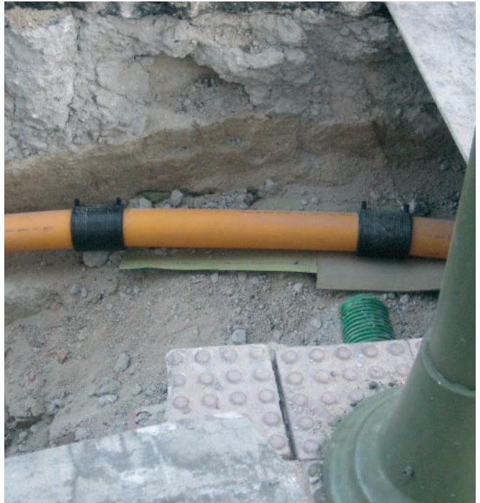
Figura 135. Tubería de gas junto a canalización de señalización de tráfico.
