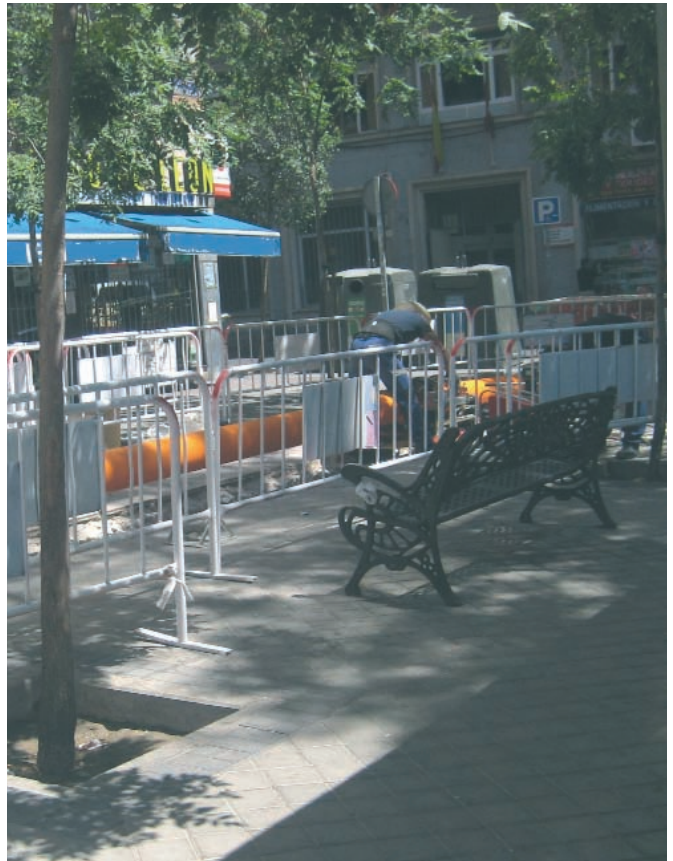
Figura 124. Ejemplos de tendido de conductos de gas, material PE , con uniones soldadas.
