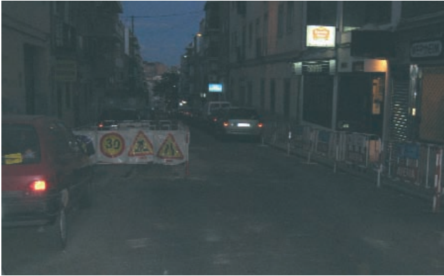
Figura 011. Señalización de obra, señales no reflectantes.
