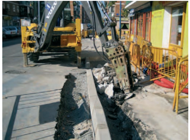
Figura 043. El tipo de terreno sobre el que se trabaja modifica los valores de exposición a vibraciones y ruido.
