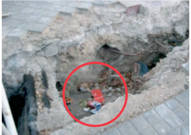
Figuras 029. Presencia de objetos ajenos a la obra.
