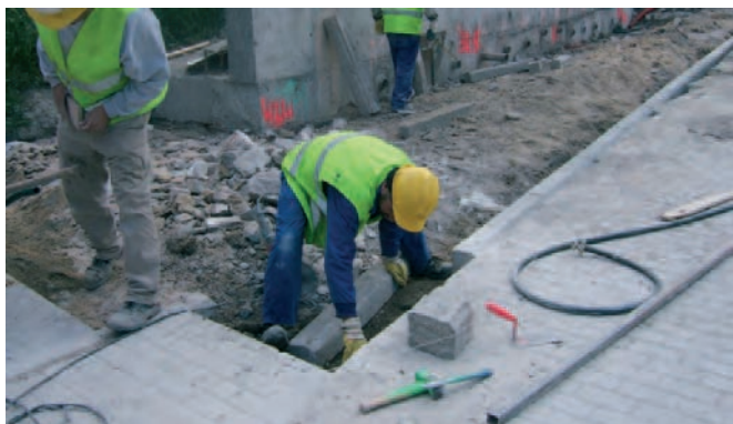
Figura 165. Las dimensiones de los bordillos dificultan poder adoptar posturas correctas durante su colocación por un único trabajador.
