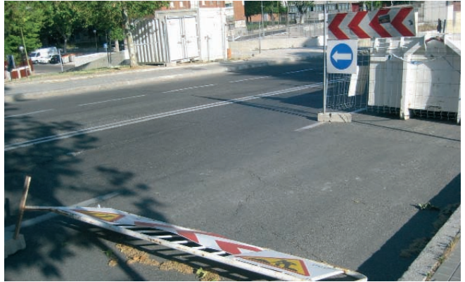
Figura 009. Inadecuada fijación del vallado.
