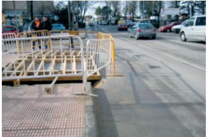
Figura 096. Afectación por vial próximo, exige un sistema de protección adecuado, no debiendo improvisar ni exponer durante el montaje.
