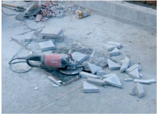
Figura 179. Radial abandonada en medio de la acera.
