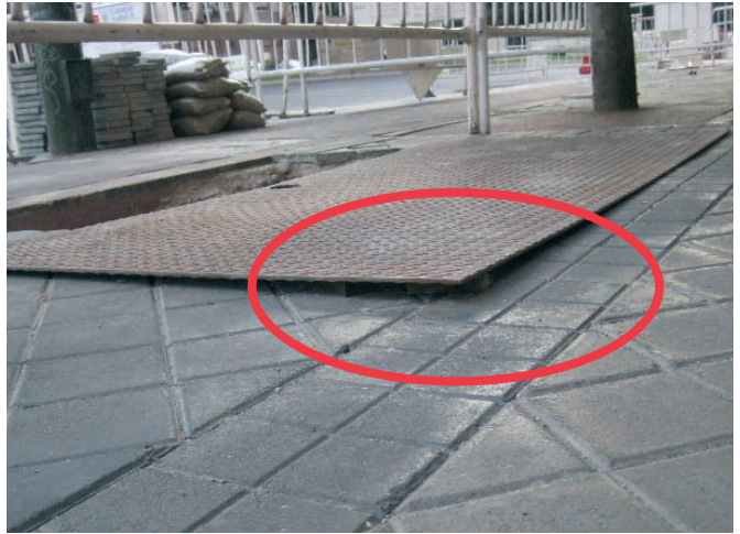
Figura 145. Chapa con las puntas levantadas, que puede dar lugar a accidentes de peatones.
