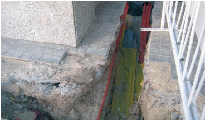
Figura 076. Conductores eléctricos al descubierto.
