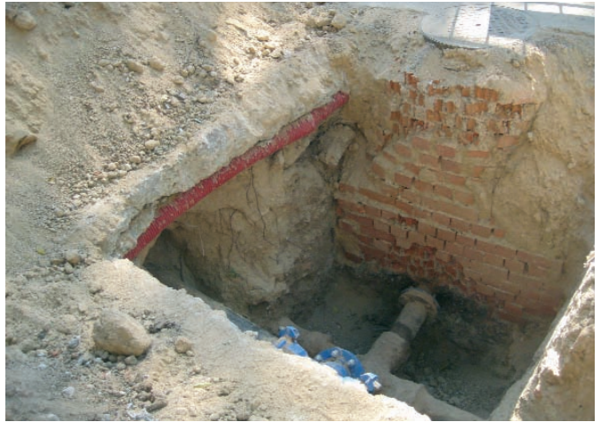
Figura 083. Acopio en borde de la cala, provocando una sobrecarga estática.
