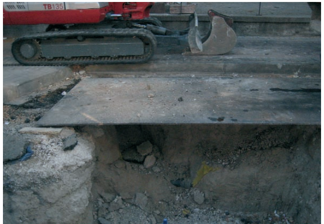
Figura 061. Apoyo de máquina sobre chapa con apoyos comprometidos.
