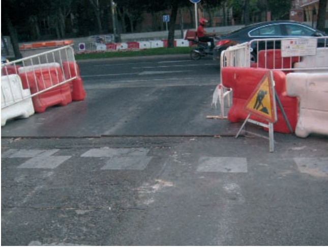
Figura 015. Vía de un único sentido con estrechamiento adecuado.
