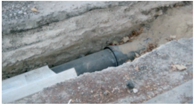
Figura 077. Tubería de agua potable.
