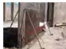
Apeo deficiente de la primera cara del encofrado mediante puntales tradicionales
