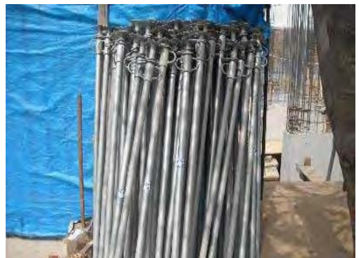
Fig. 80 – Acopio inadecuado de puntales una vez realizado el desencofrado.
