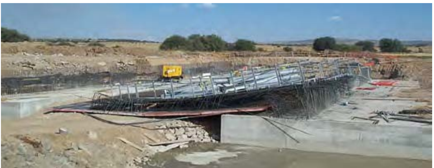
Fig. 13 - Desplome de encofrado y armadura con andamio en ejecución de muro.
