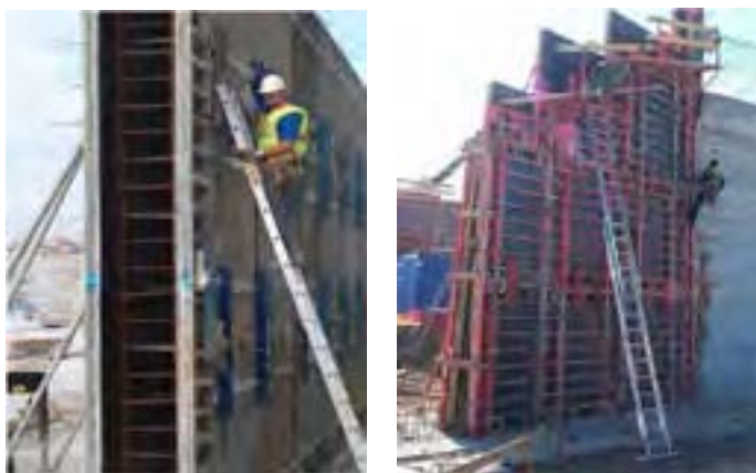
Fig. 8 - Trabajo de montaje de elementos auxiliares en encofrados verticales desde escalera de mano y con empleo de arnés de seguridad.
