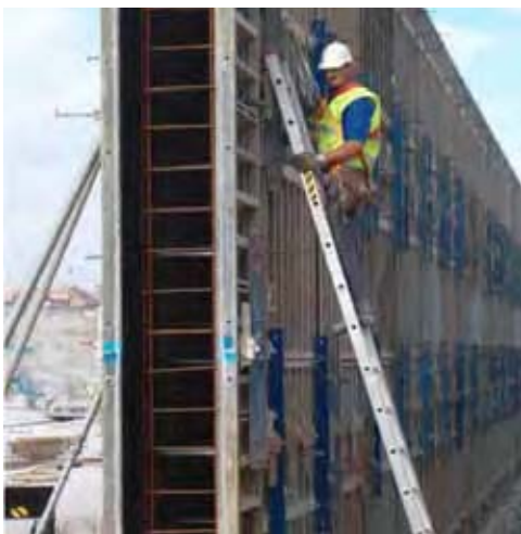
Fig. 85 – Usos incorrectos de las escaleras de mano en encofrados
