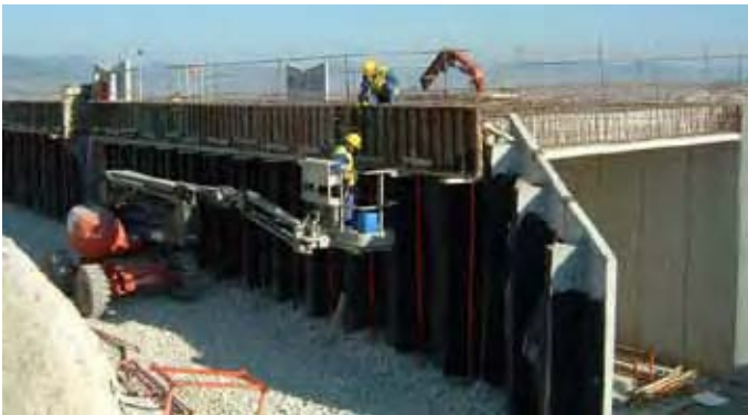
Fig. 76 - Utilización de PEMP en el montaje de encofrado de losa de paso inferior de carretera.
