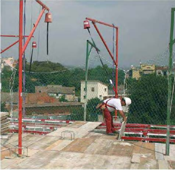
Fig. 57 - Sistema de percha para utilización de arnés de seguridad
