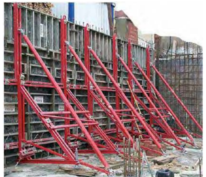
Fig. 78 Apeos y arriostramiento en encofrados a una cara. El primero está constituido con puntales tradicionales, los cuales no garantizan la transmisión de cargas. El segundo corresponde a las tornapuntas de un sistema de encofrado.
