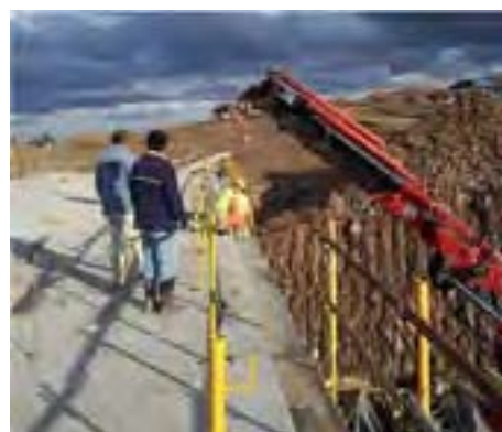
Fig. 48 – Falta de planificación en los trabajos de desencofrado y en la instalación de protecciones.
