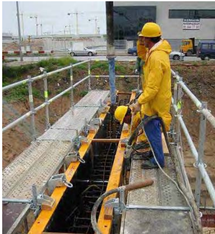
Fig. 79 Hormigonado y vibrado con plataformas a ambos lados de coronación del encofrado.
