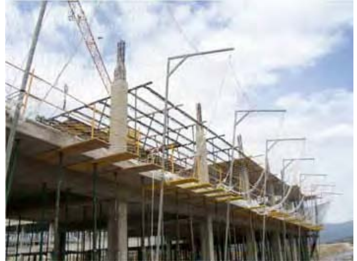
Fig. 53 - Redes tipo horca en forjados de edificación
