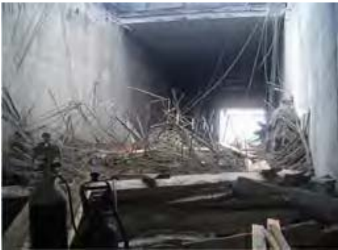
Fig. 15 -Desplome de cimbra y encofrado de losa superior de falso túnel.
