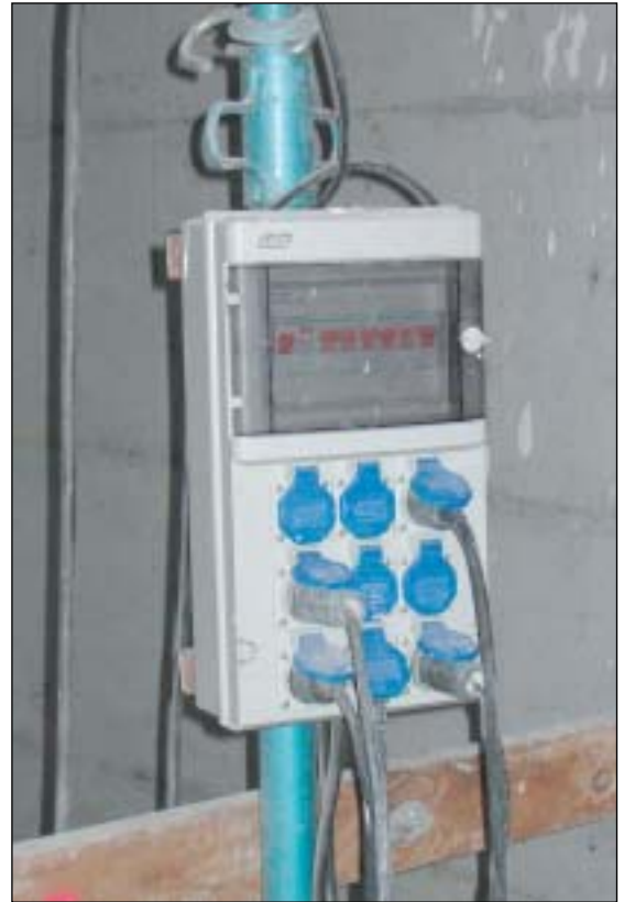
Cuadro eléctrico auxiliar
