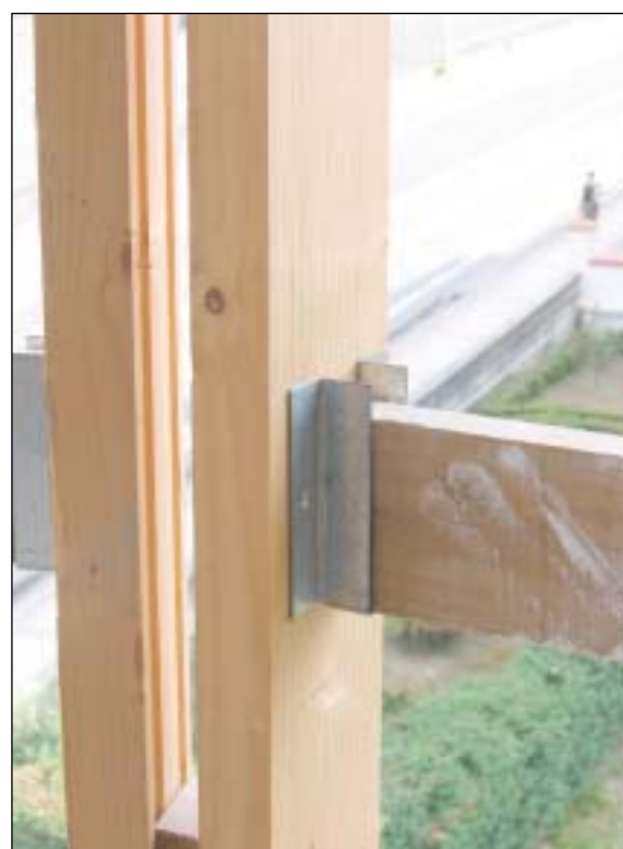
Protecciones de huecos
