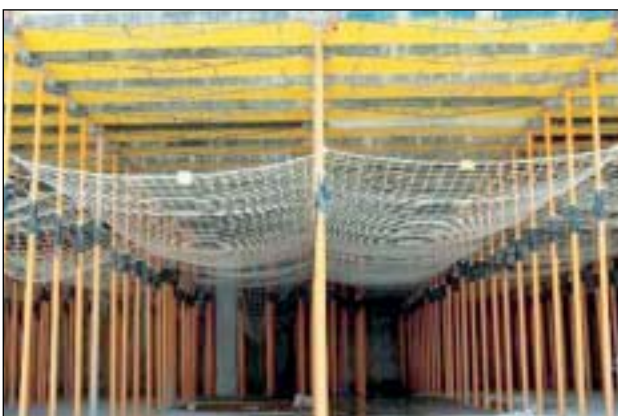
Redes bajo forjado
