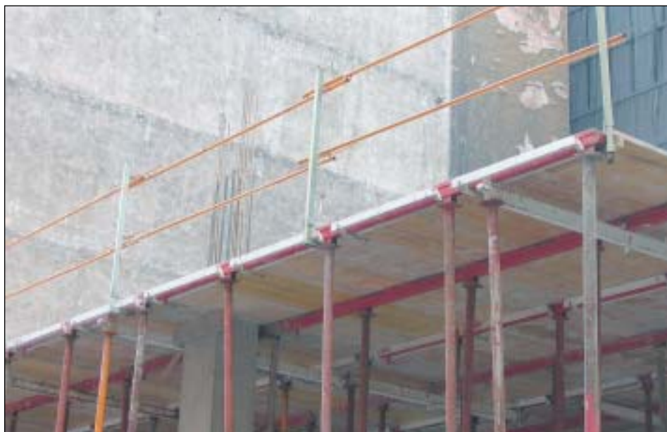
Proteccion de borde
