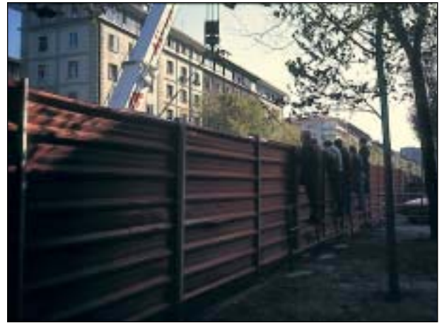
Vallado de obra
