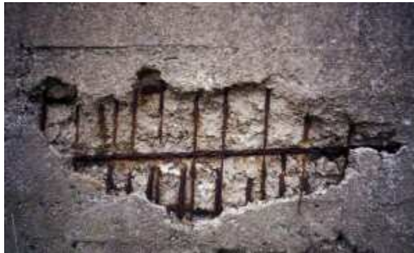
Fig. 1.1. Fotografía de una armadura corroída (www.e-construccion.cl; 29 marzo 2011)
