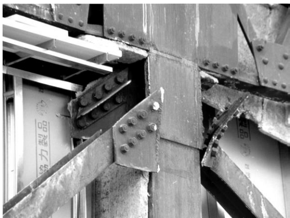
Fig. 1-17. Fractura en una conexión soldada (Naeim, 2001).
