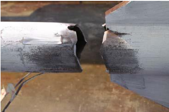
Fig. 4-20. Fractura de una riostra en la sección neta (Fu et al., 2007)
