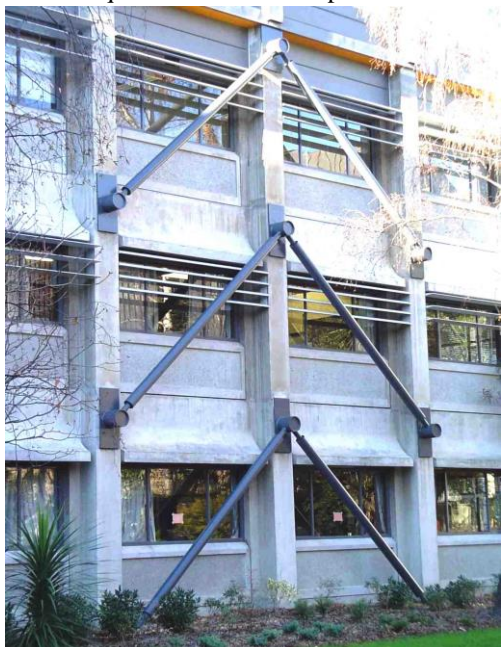
Fig. 2-24. Ejemplo de rehabilitación mediante el agregado de riostras de acero a una estructura de hormigón armado.
