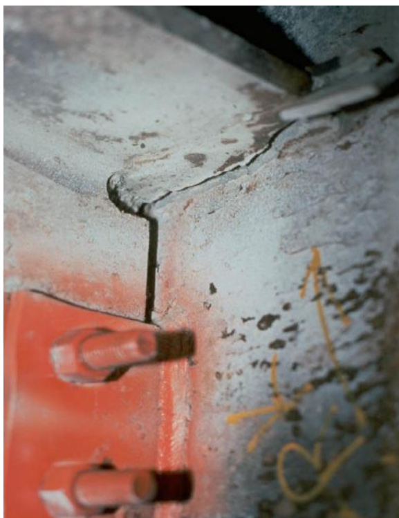
Fig. 1-13. Fractura de la soldadura de penetración completa en una conexión de pórtico resistente a momento (Earthquake Engineering Research Institute,
