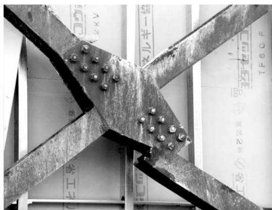
Fig. 1-15. Fractura de una riostra en X en la sección neta (Naeim, 2001).
