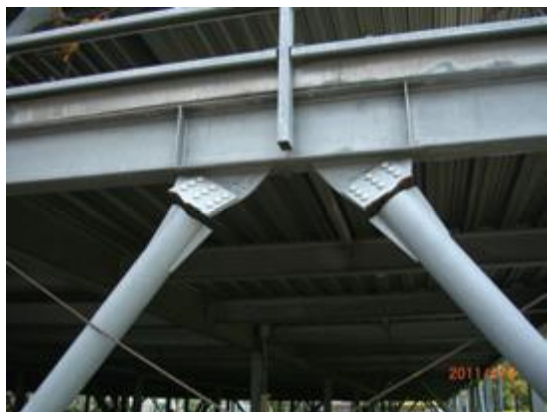
Fig. 1-18. Fractura de riostras en la zona de conexión (Midorikawa et al., 2012).
