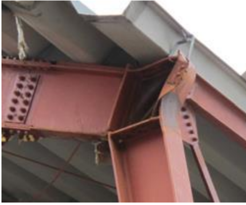
Fig. 3-8. Deformación del panel nodal por acción del sismo (Midorikawa et al., 2012).
