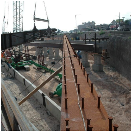
Fig. 1-32. Imagen de una viga de acero con pernos de corte para construcción de la viga compuesta de un puente.
