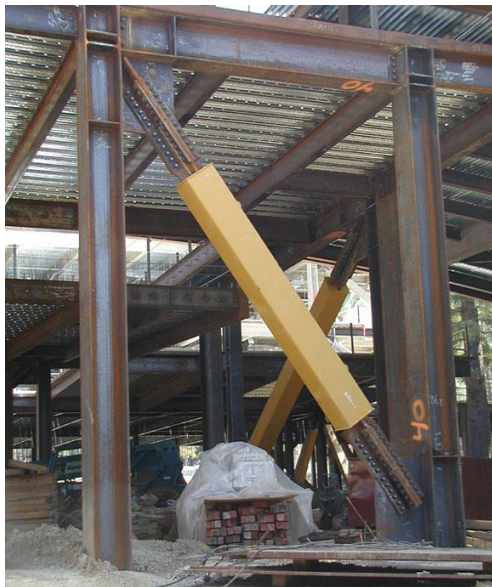
Fig. 2-32. Vista de una riostra de pandeo restringido utilizada en nuevo edificio de la Universidad de California, Berkeley (Cortesía de National Information Service for Earthquake Engineering, EERC, University of California, Berkeley).
