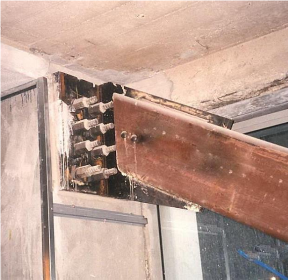
Fig. 4-36. Detalle de la conexión de una riostra de acero al nudo de un pórtico existente de hormigón armado.
