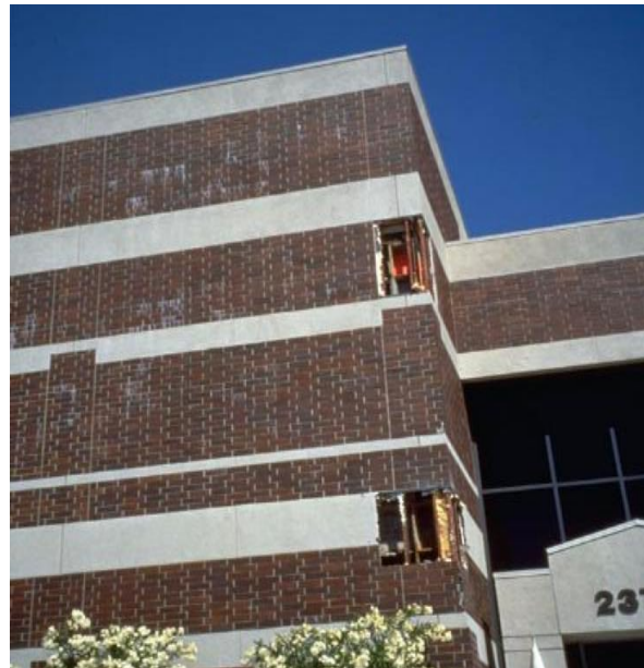
Fig. 1-11. Edificio bajo inspección para observar los daños causados por el terremoto en las conexiones viga-columna (Earthquake Engineering Research Institute, Slides on the January 17, 1994, Northridge Earthquake, Set I: An Overview).
