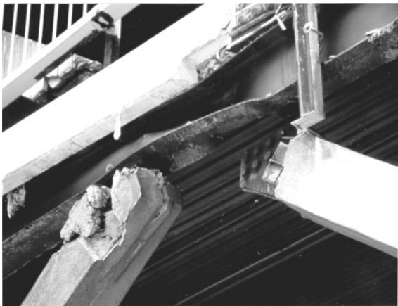
Fig. 1-16. Daño severo en la viga y conexión de un pórtico con arriostramientos en V invertida (Naeim, 2001).
