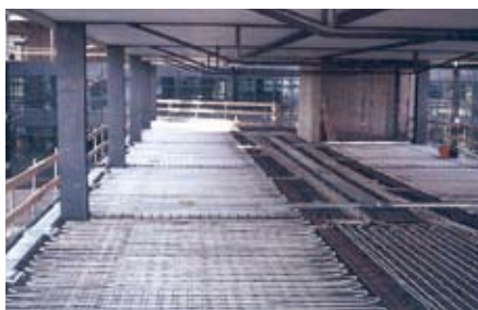
Sistema de climatización por agua localizado en la losa del forjado
