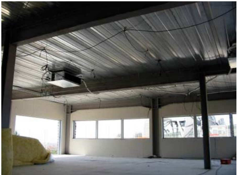
Figura 4.4 Vista inferior de la placa Cofradal terminada. Instalación de falso techo para la integración de servicios
