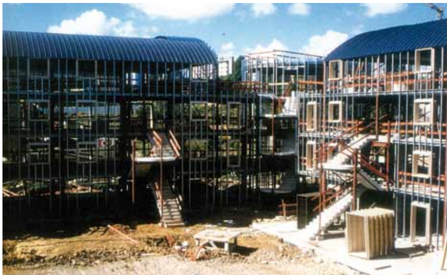
Figura 8.10 El sistema PRISM durante su construcción: estructura de acero, cubierta y paneles de fachada exteriores para su posterior cerramiento
