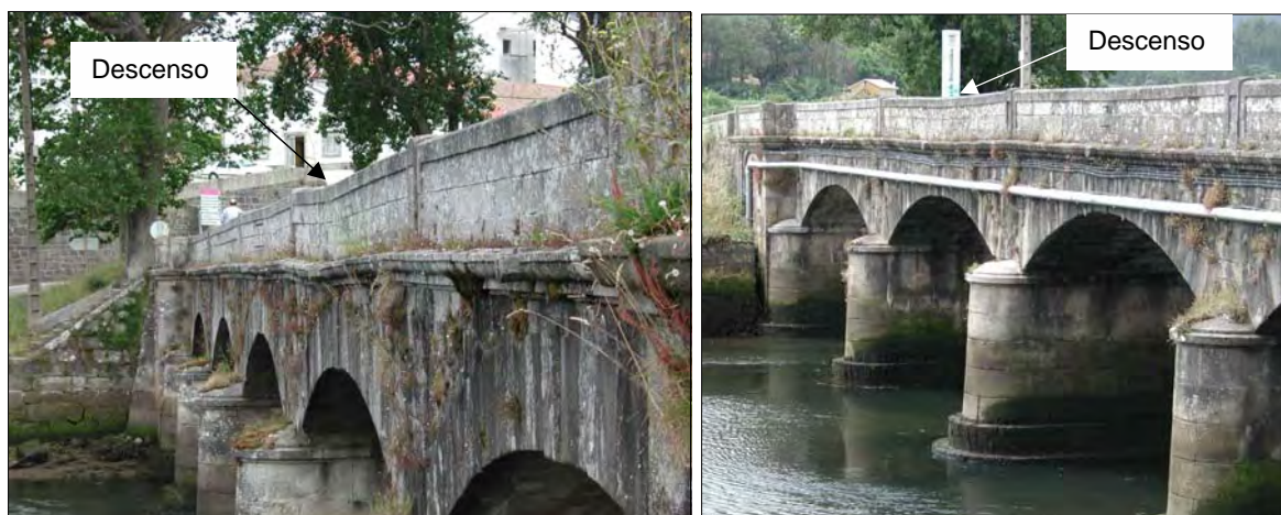
Figura 6.2.4 Asentamiento de la segunda bóveda manifestado en el pretil, vista aguas abajo (izq.) y aguas arriba (der.)
