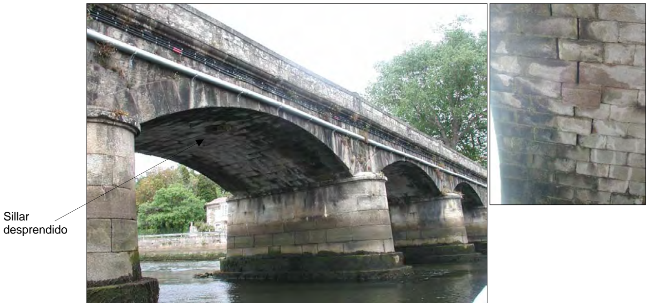
Figura 6.2.5 Vista del intradós de la segunda bóveda y detalle del sillar desprendido y fisuración longitudinal
