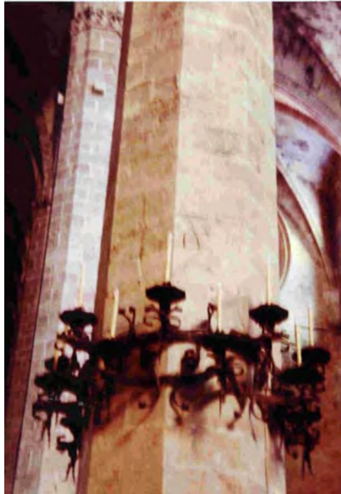
Figura 6.1.4 Fisuración vertical detectada en una de las pilas de la cuarta crujía
