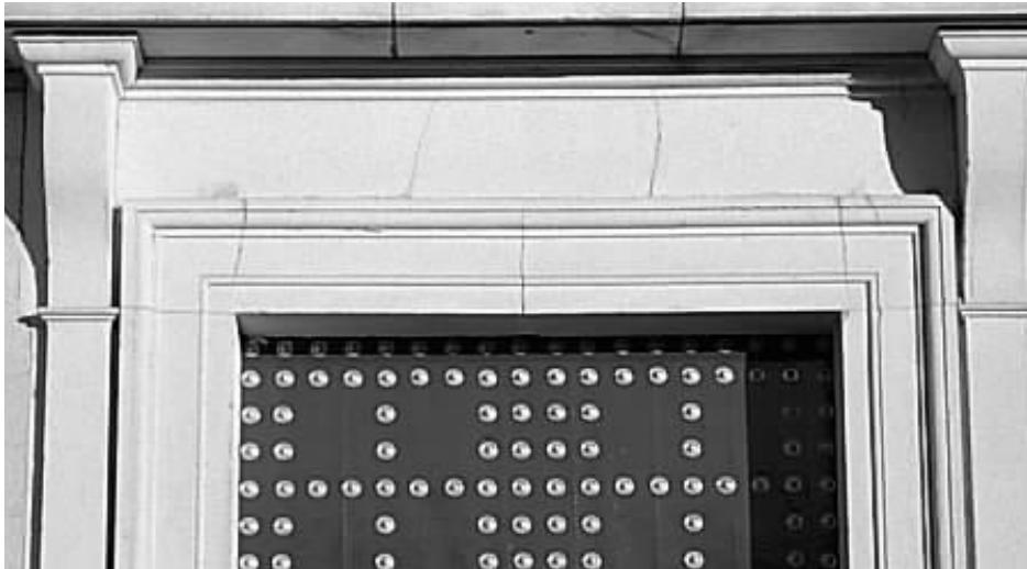
Figura 5.17 Dintel partido en el vano (intrados) y en apoyos (extrados) en la fachada del Monasterio del Escorial
