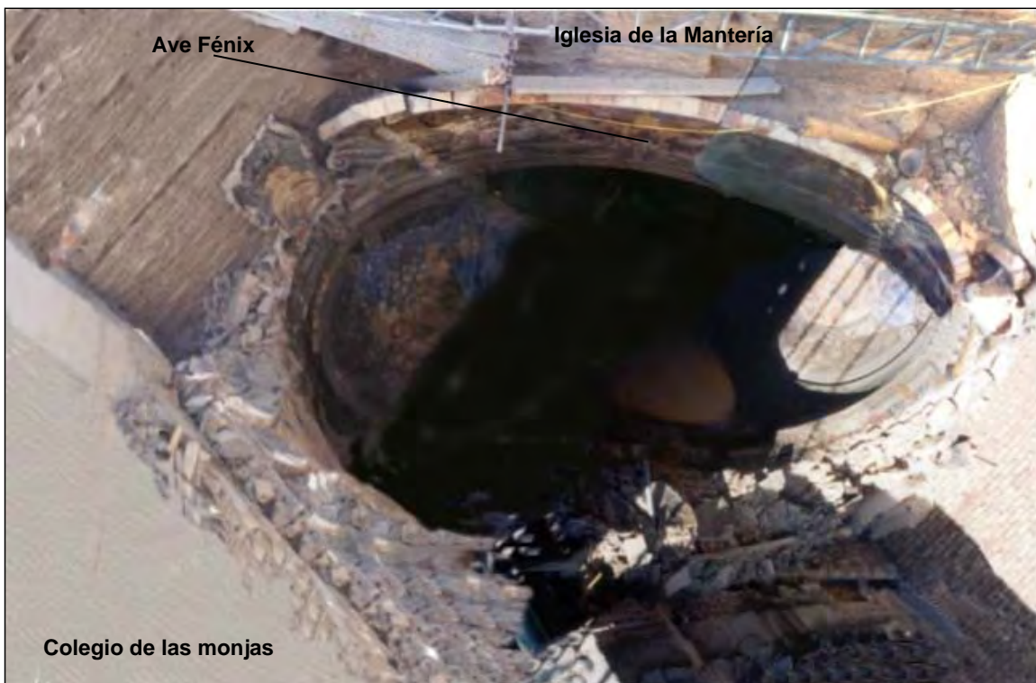
Figura 6.3.3 Vista elevada de la Cúpula del Evangelio tras el colapso. A la izquierda el muro alledaño del colegio de las monjas Escolapias, a la derecha la iglesia. Se marca la posición del ave fénix en el lado de la iglesia.
