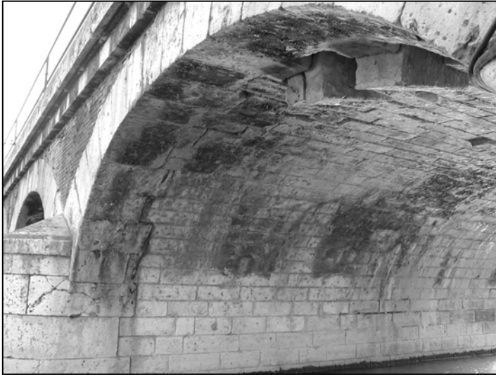
Figura 5.46 Pérdida de sillares en un puente ferroviario de sillería por causas no estructurales [122]
