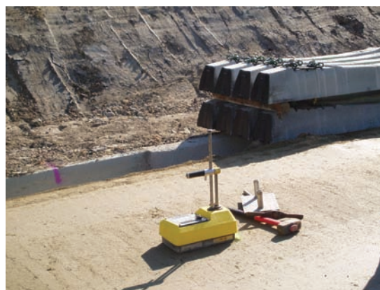
Equipo de control de la densidad
