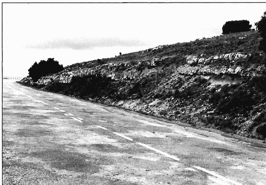
Foto 13.— Alternancia de estratos calizos y margas del grupo 321c sobre las margas del grupo 321e que configuran la base del talud. Inicio del descenso de la carretera N-120 desde el páramo inferior al valle del río Hormazuelas por la ladera de la margen izquierda del arroyo del Plantío.
