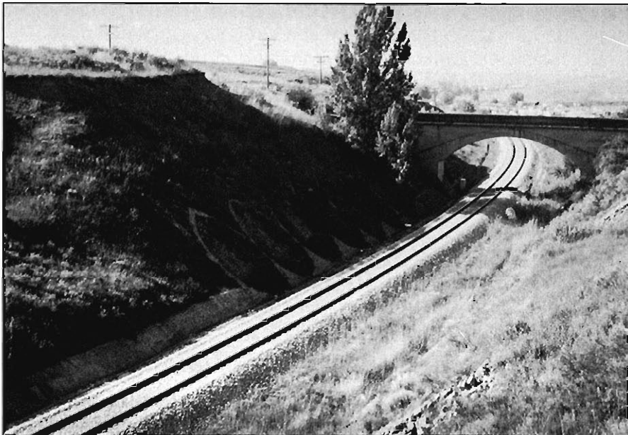
Foto 26.— Trinchera del ferrocarril a la altura de Villacienzo, excavada en el grupo 321f2 y en el recubrimiento representado por el glacis-terrazza constitutivo del grupo t. La inestabilidad del talud se intenta corregir con un muro de arcos ojivales.
