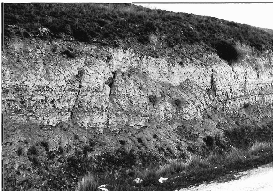
Foto 20.— Pequeños desplomes en el talud excavado en las margas del grupo 321f1, junto al p.k. 19 de la carretera local que une Castellanos de Castro con Castrojeriz.
