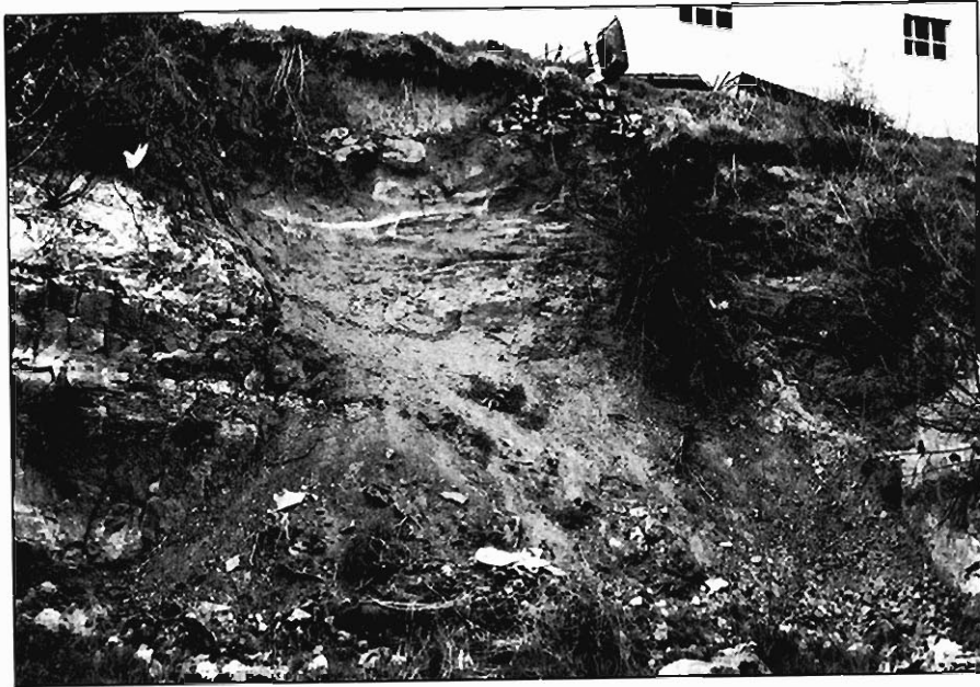
Foto 40.— Arcillas, limos, arenas y areniscas, de tonos rojos, del grupo 321h. Talud de excavación junto al pueblo de Cobia, afectado por un desplome.
