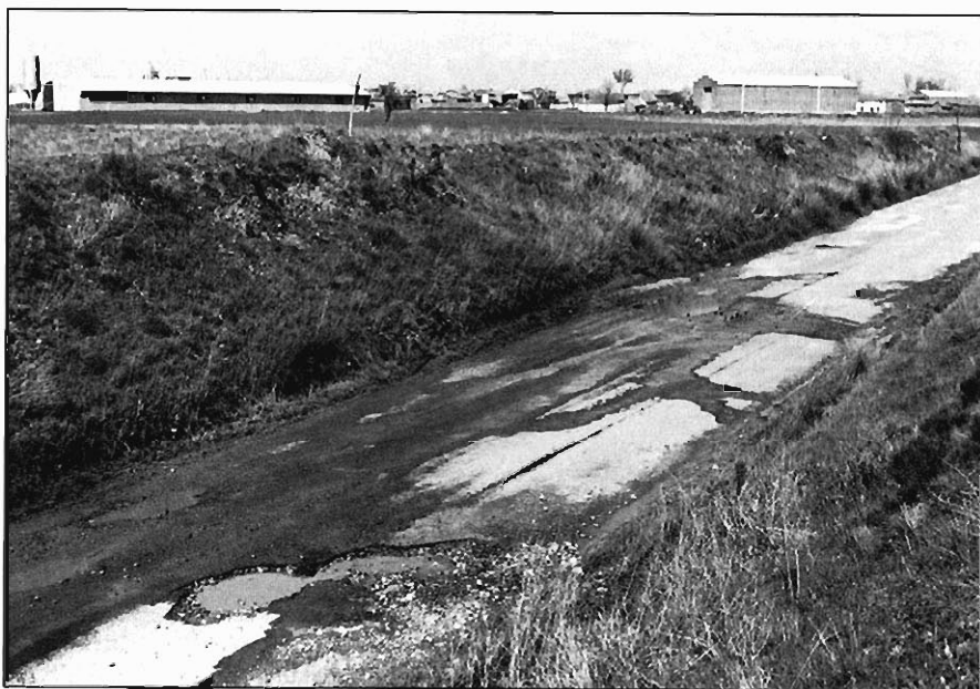
Foto 36.— Surgencias de agua en el contacto entre la terraza del grupo T3 y el grupo 321h, junto a la población de Arenillas de Riopisuerga. La carretera se ve afectada por este hecho al no existir un drenaje efectivo de las aguas.
