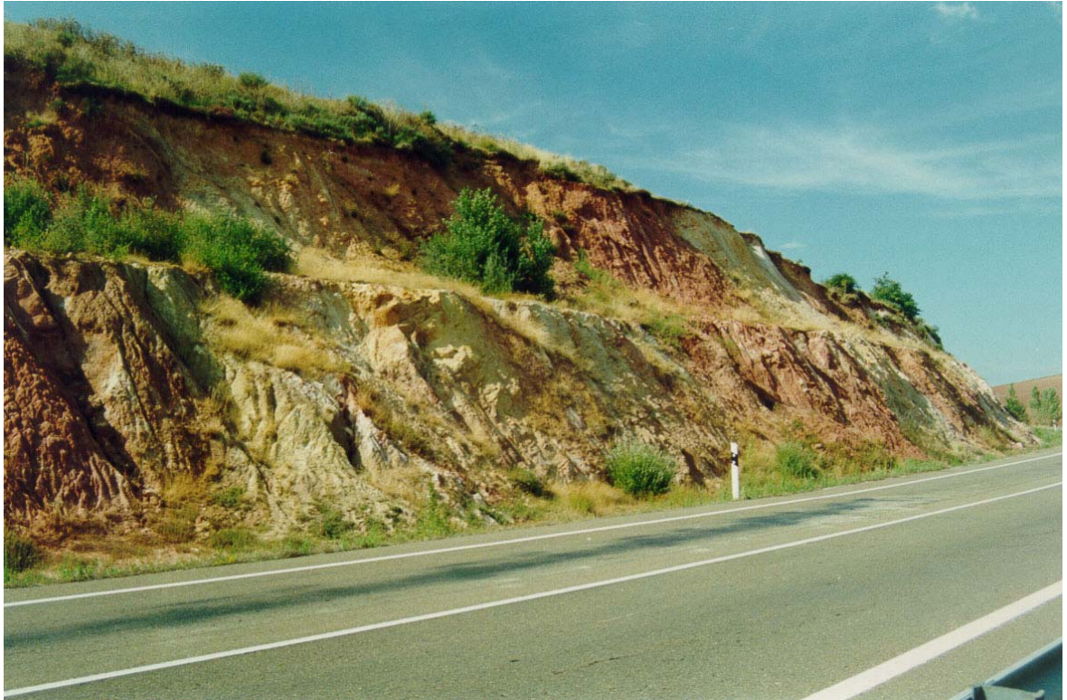
FOTO N° 43. Desmante situado en el P.K. 104+400 de la N-611, donde afloran arenas, lutitas, margas y areniscas, pertenecientes en conjunto al grupo 231a (F. Purbeck). Sobre los taludes se observan erosiones, acarreamientos y deslizamientos superficiales de los términos más alterados.
