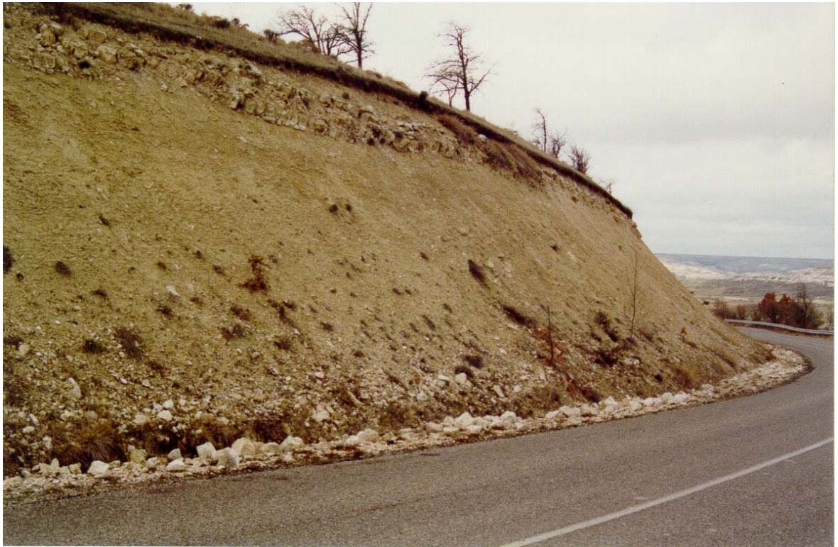
FOTO N° 6. Margas con niveles de margocalizas aflorando en el talud de un desmonte situado en el P.K. 13+500 de la carretera local (BU-622), entre Arroyal y Mansilla de Burgos. Se originan caídas de pequeños bloques del nivel superior de margocalizas, por erosión diferencial.
