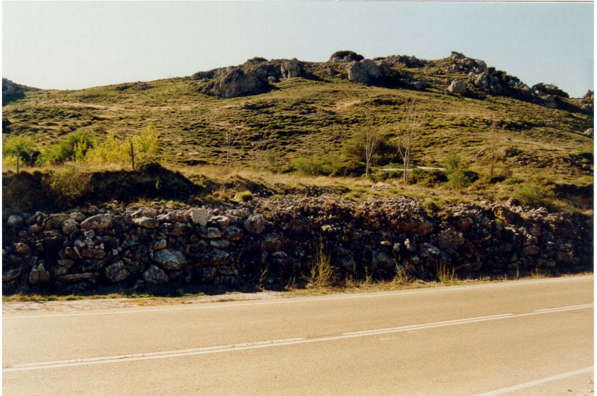
FOTO N° 35. Deslizamiento de la ladera situada en el P.K. 82+000 de la carretera local entre Brullés y Coculina. El deslizamiento afecta a las margas del grupo 232a y su recubrimiento coluvio-eluvial, y ha motivado la necesidad de colocar una escollera al pie de la ladera en este punto.
