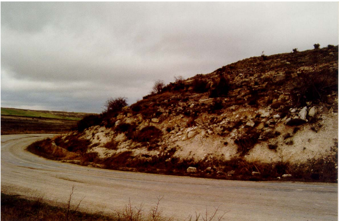
FOTO N° 5. Deslizamiento del talud de la carretera local que conduce desde Pedrosa de Río Urbel a San Pedro Samuel, muy próximo a esta última localidad, en la cuesta del páramo. El deslizamiento ha afectado a los materiales del grupo 321c, constituidos por una alternancia de calizas, margocalizas y margas. Al pie del talud se observan afloramientos de agua.
