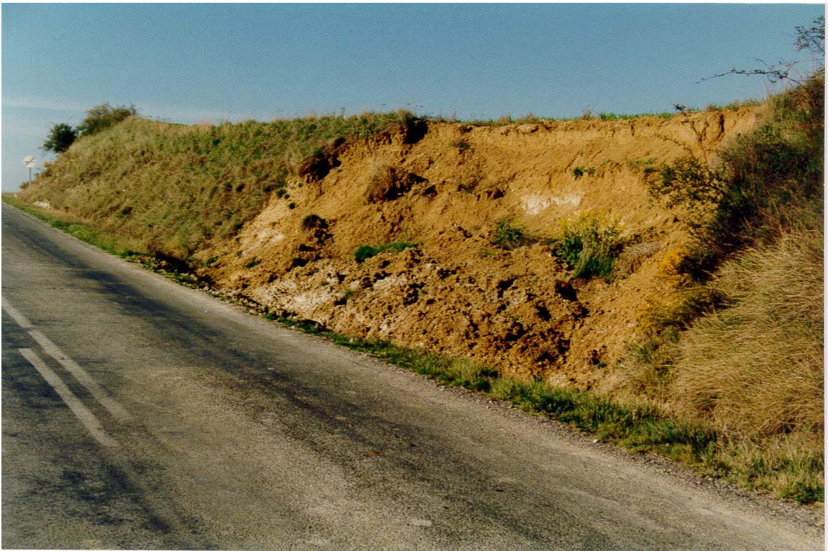
FOTO Nº 10. Deslizamiento de tierras en un talud situado en el P.K. 76+400 de la carretera local entre Melgosa de Villadiego y Brullés. El recubrimiento cuaternario se ha visto inestabilizado a favor del contacto con las margas del grupo 321h, que constituyen el substrato, en un punto donde se observan afloramientos de agua.
