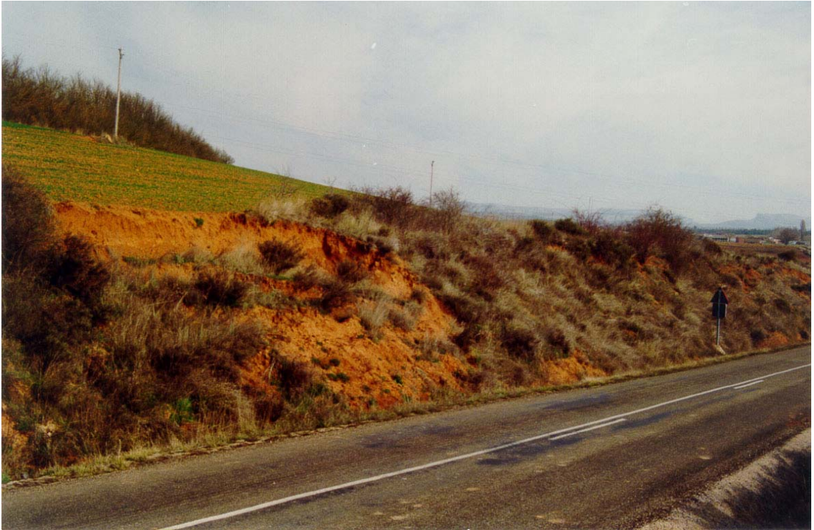
FOTO Nº 18. Deslizamiento de tierras en un talud situado en el P.K. 63+600 de la carretera comarcal C-627, entre Sotovellanos y Herrera de Pisuerga. El deslizamiento afecta a los fangos de la formación 300a, cuyas condiciones de estabilidad se han visto degradadas por la presencia de un horizonte freático en la base del desmonte, a favor de un paleocanal arenoso.
