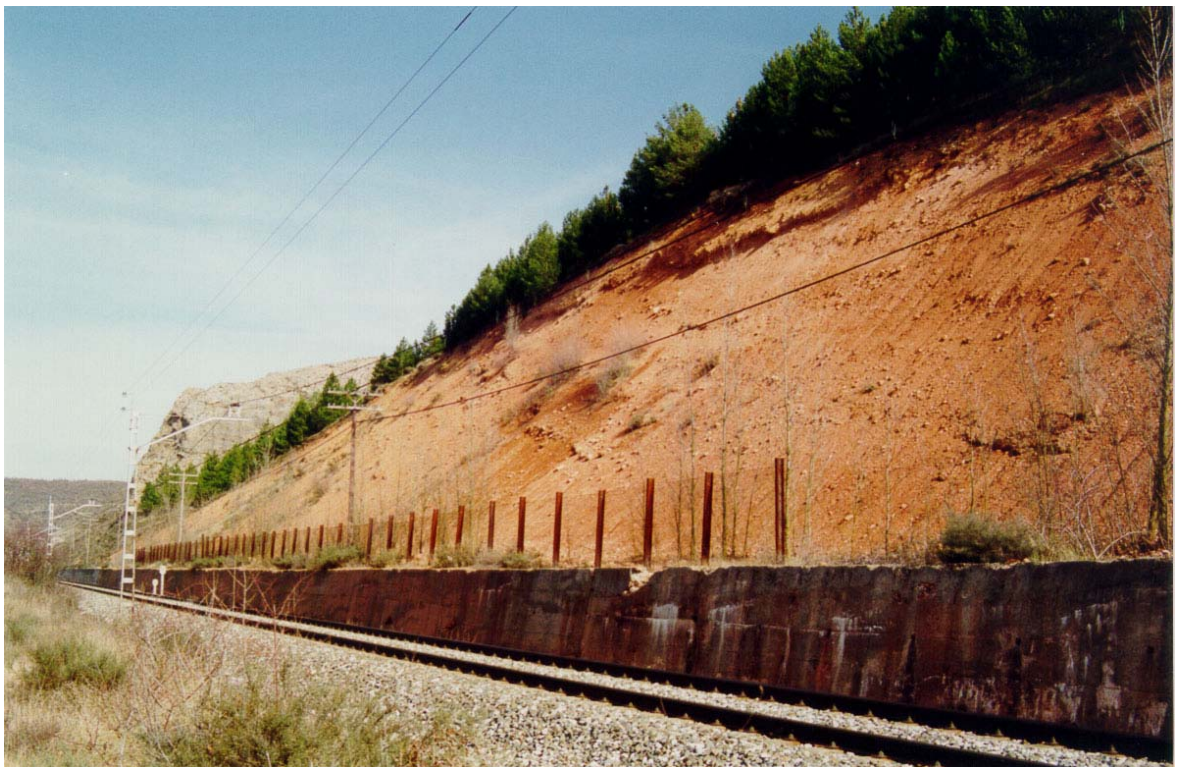
FOTO Nº 24. Desmorte del ferrocarril Palencia-Santander, en el P.K. 380+400, practicado en los conglomerados calcáreos del grupo 300c. La débil cementación que presentan estos materiales, en este punto, ha favorecido la acción de los procesos erosivos que provocan arrastres de tierras y caídas de bloques y gravas. Por ello ha sido necesario la construcción de un muro de contención de hormigón recrecido con una barrera metálica, para evitar que los arrastres inunden la plataforma.
