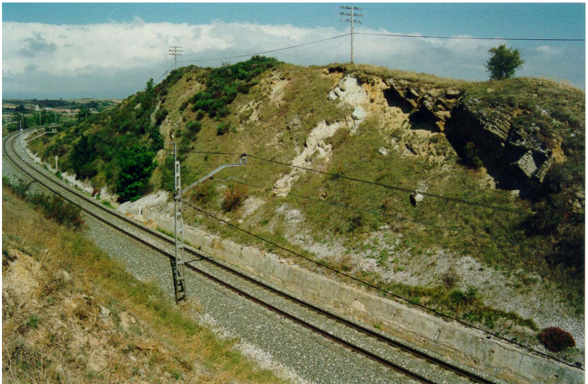
FOTO Nº 48. Trincheras del ferrocarril Palencia-Santander, P.K. 400+000. Caída de bloques por descalce y vuelco de estratos en un paquete de areniscas del grupo 231a incluido en una serie lutítica perteneciente al grupo 230c. F. Purbeck.
