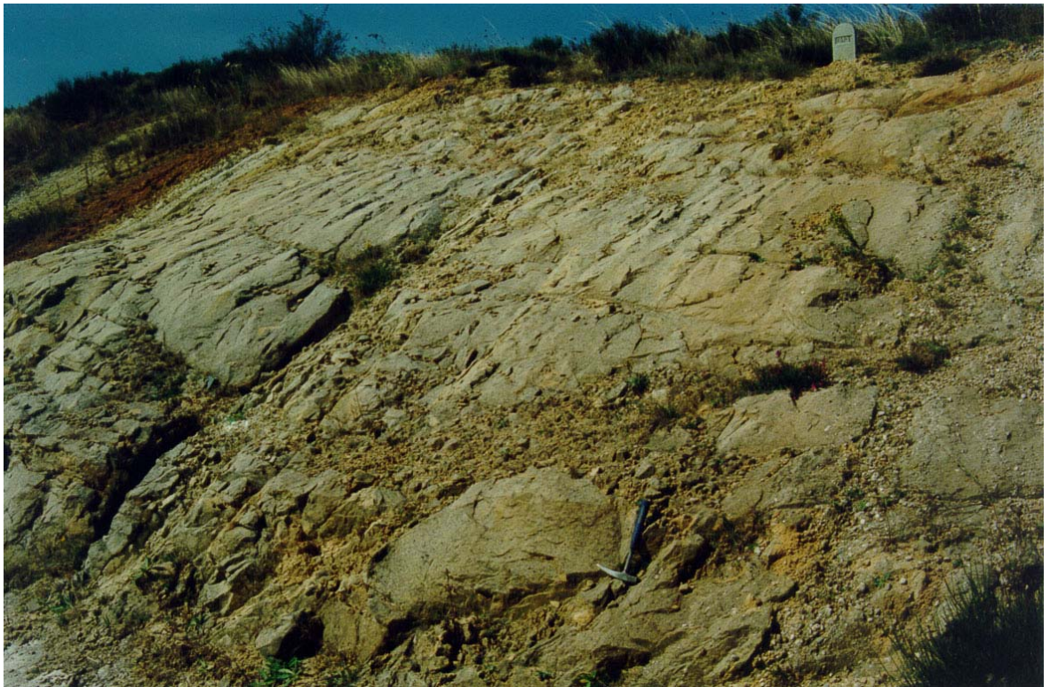
FOTO N° 40. Desmonte situado en el P.K. 113+100 de la N-611, donde afloran niveles, de espesor métrico, de areniscas y conglomerados de la F. Purbeck, fuertemente cementados; pertenecientes al grupo 231a.
