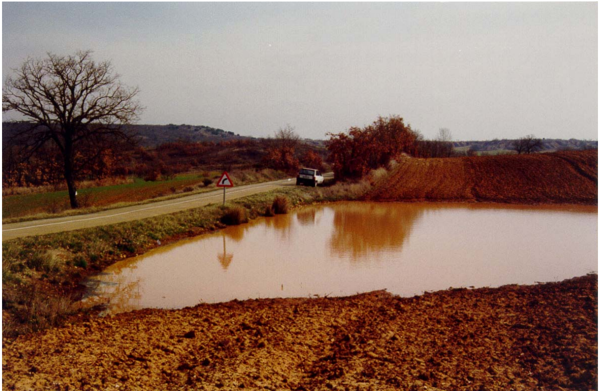
FOTO N° 16. Encharcamiento sobre los fangos del grupo 300a al quedar cegada una vaguada por el terraplén de la carretera autonómica P-232, en el P.K. 2+200, y carecer ésta de obra de drenaje transversal.
