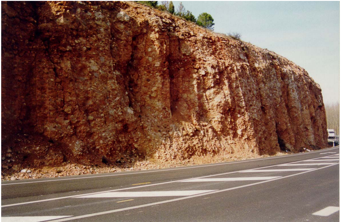
FOTO N° 25. P.K. 93+000 de la carretera N-611. Desmonte practicado mediante voladuras, en la formación de conglomerados calcáreos del grupo 300c, fuertemente cementados. En el talud se observan planos de fractura y conductos kársticos, que individualizan bloques que pueden verse inestabilizados.
