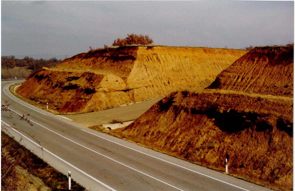
FOTO N° 15. Desmonte en los fangos de la Facies Grijalba-Villadiego (Grupo 300a) situado en el P.K. 69+800 de la carretera N-611. En los taludes se observan erosiones y deslizamientos superficiales por alteración de los fangos, debida a las aguas de escorrentía y a las que afloran por el talud a favor de los paleocanales arenosos.
