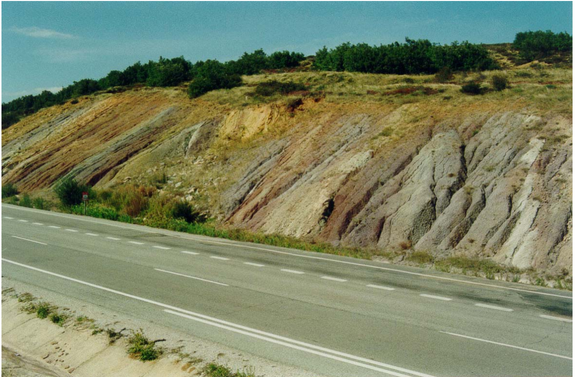
FOTO N° 44. Desmonte situado en el P.K. 113+000 de la N-611. Afloran lutitas de la F. Purbeck (grupo 230a), en ciclos de oxidación/reducción, y se observan fuertes acarreamientos y un deslizamiento de tierras, donde se ha colocado una escollera al pie.
