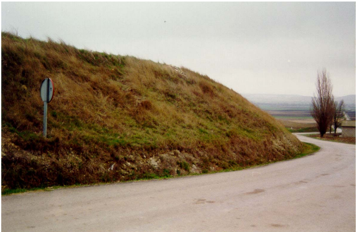
FOTO N° 9. Desmonte situado en la carretera local de Sotragero a Villanueva de río Ubierna, en las proximidades de esta última localidad. Sobre el talud se manifiestan signos de inestabilidad que afectan a margas, yesos y arcillas de la F. Villatoro (grupo 321g).
