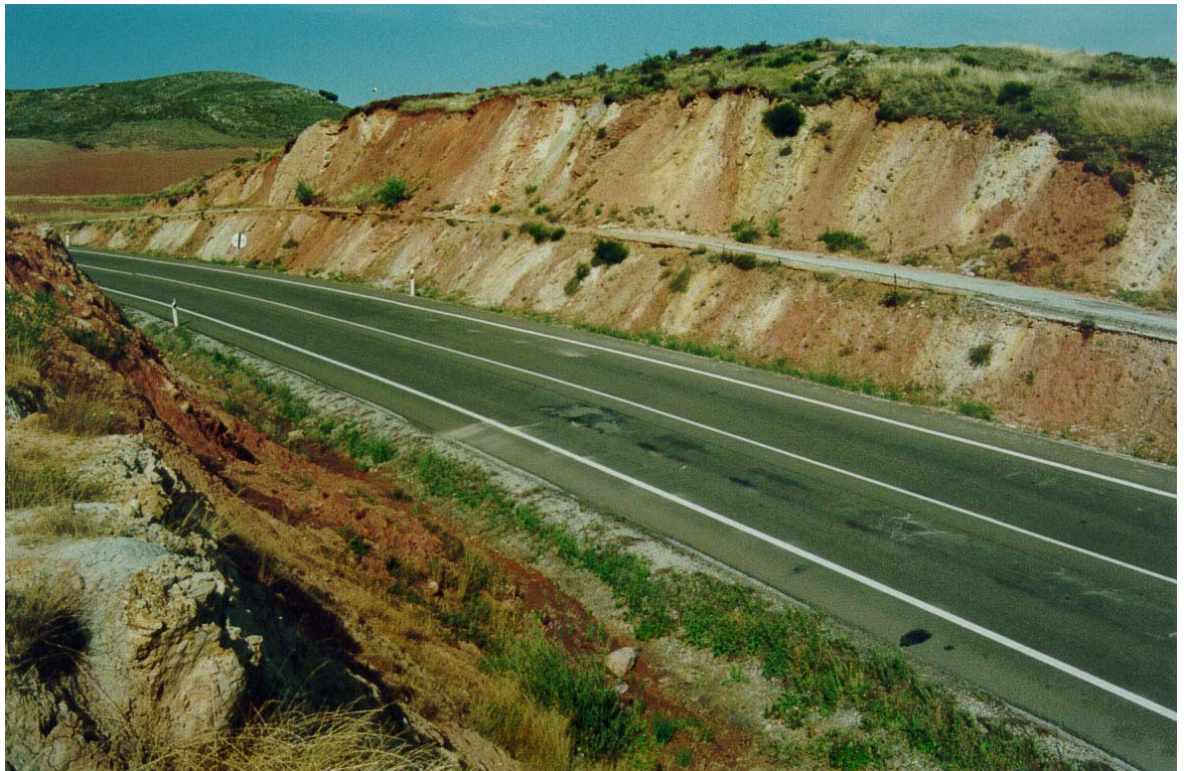
FOTO N° 42. Desmonte situado en el P.K. 104+400 de la N-611, donde afloran arenas, lutitas, margas y areniscas, pertenecientes en conjunto al grupo 231a (F. Purbeck). Sobre los taludes se observan erosiones, acarcavamientos y deslizamientos superficiales de los términos más alterados.
