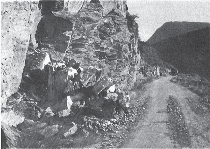
Foto 3-23 — Desprendimientos en la carretera de Congosto a Santa Marina de Sil en los materiales Ordovícicos.
