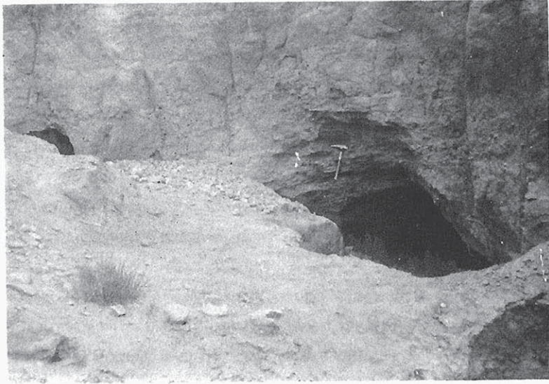
Foto 3-6 — Erosión interna de las arcillas arenosas (32a).
