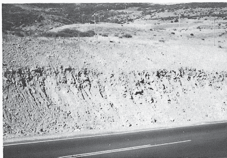
Fig. 10. Detalle de los coluviales de Somosierra que aparecen entre los kilómetros 94 y 95 de la C. N.-1
