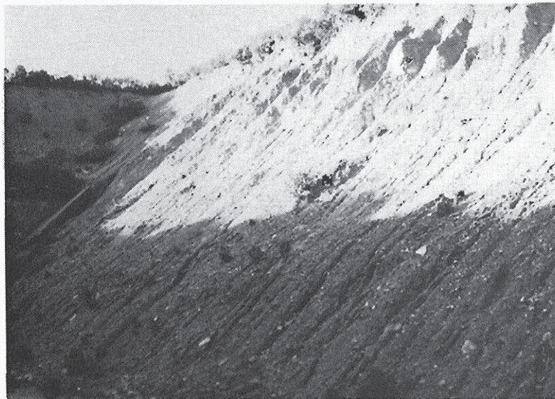
Fig. 21. Talud del FF. CC. Madrid-Burgos en las proximidades de la C. N. Soria-Plasencia; tiene 50° de pendiente continua y de 12 a 15 metros de altura
