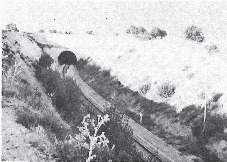
Fig. 45. Arcillas margosas que aparecen en el talud del FF. CC. Madrid-Burgos, paralelamente a la carretera Sta. Cruz de la Salceda-Linares del Arroyo, a la altura del kilómetro 40. Boca norte del túnel
