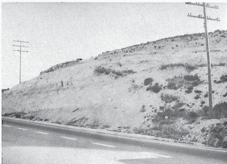
Fig. 47. Talud de la C. N.—1 Madrid-Burgos en el kilómetro 150, constituido por calizas pontienses sobre margas blancuecinas
