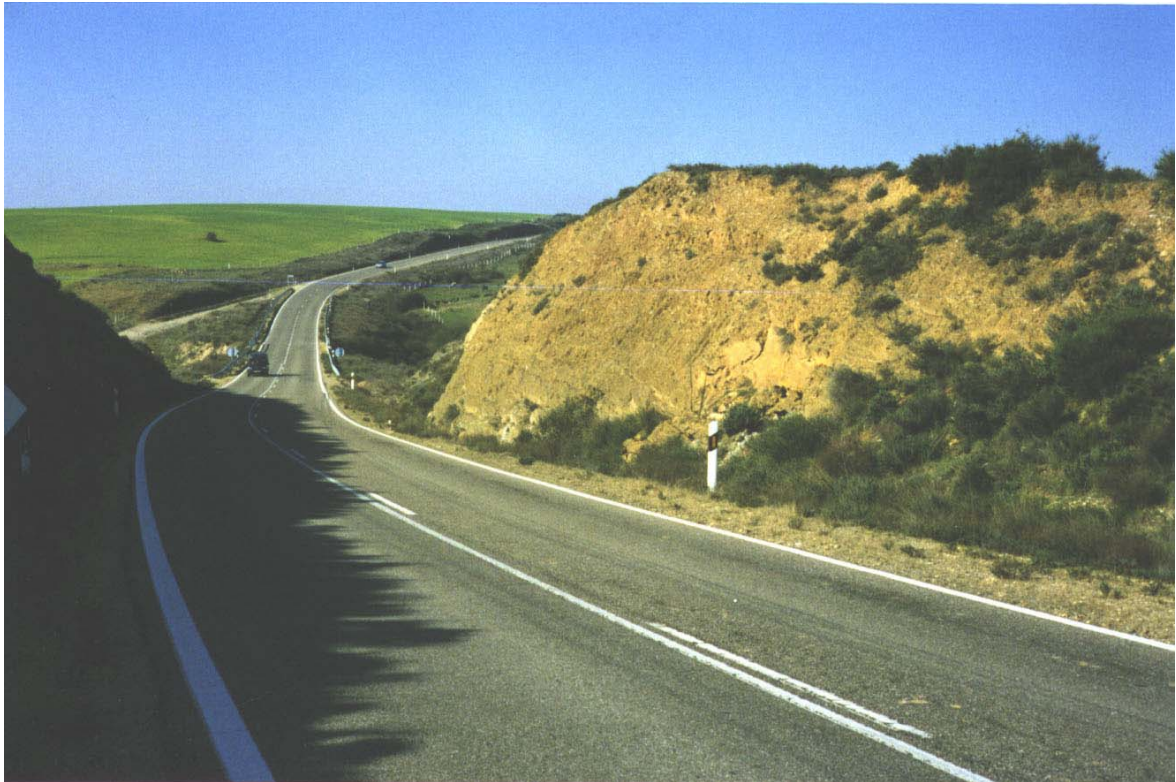
Figura 3.48. Talud de baja altura realizado en los esquistos del grupo (010b), en el p.j. 10 de la carretera C-527 (Hoja 397-4). Puede observarse la caída de una pequeña cuña en el pie del mismo.
