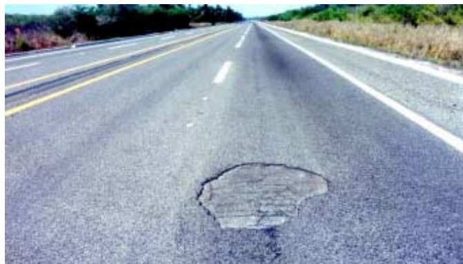
Fig: Detalle de peladura en el pavimento
