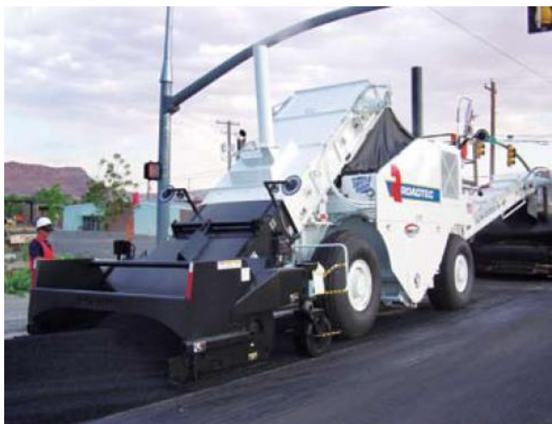
Fig: Cabeza de recogida de material asfáltico en cordón en el silo de transferencia
