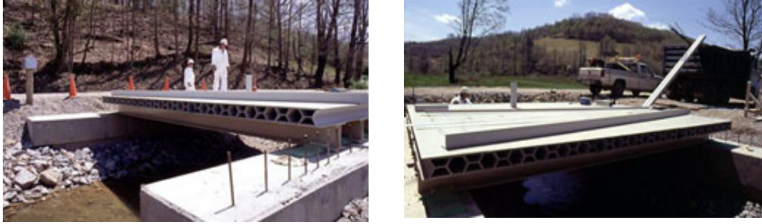
Figura 3.26: Aplicación de materiales compuestos en puente Wichwire Run en West Virginia, EEUU.
