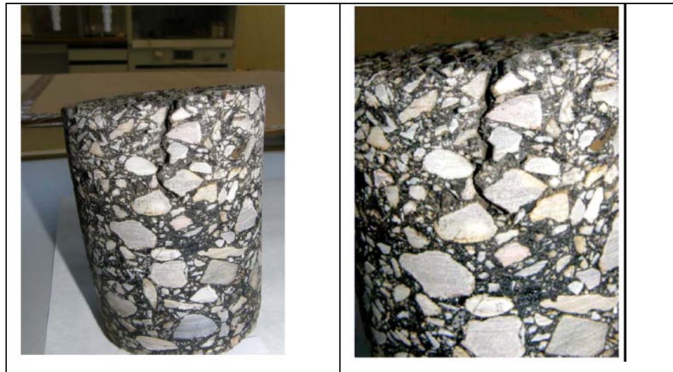
Fig.2.- Testigo en el que se observa fisuración descendente
