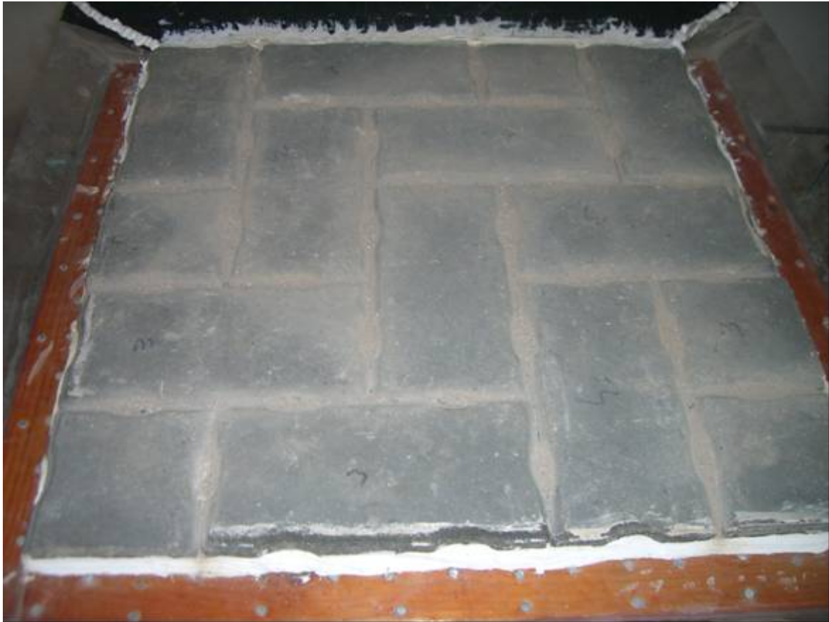
Figura III-12. Pavimento de adoquines con ranuras colmatado al máximo.
