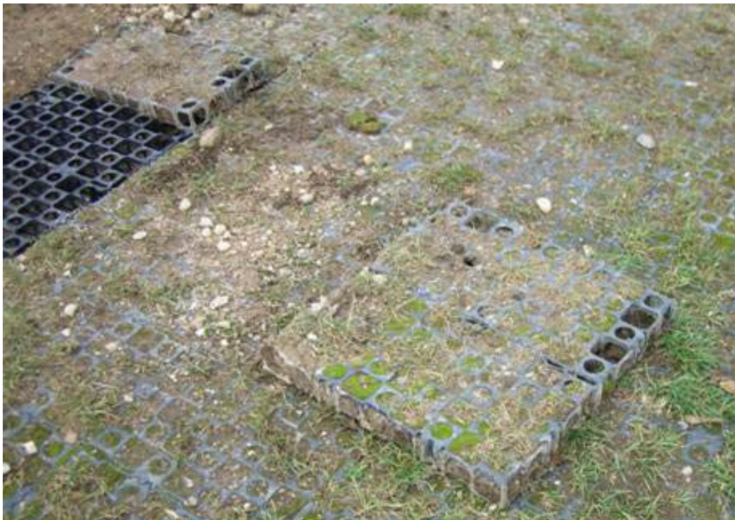
Figura II-2. Césped con refuerzos de plástico, aparcamiento del Palacio de Deportes de la Guía, Gijón, Asturias.
