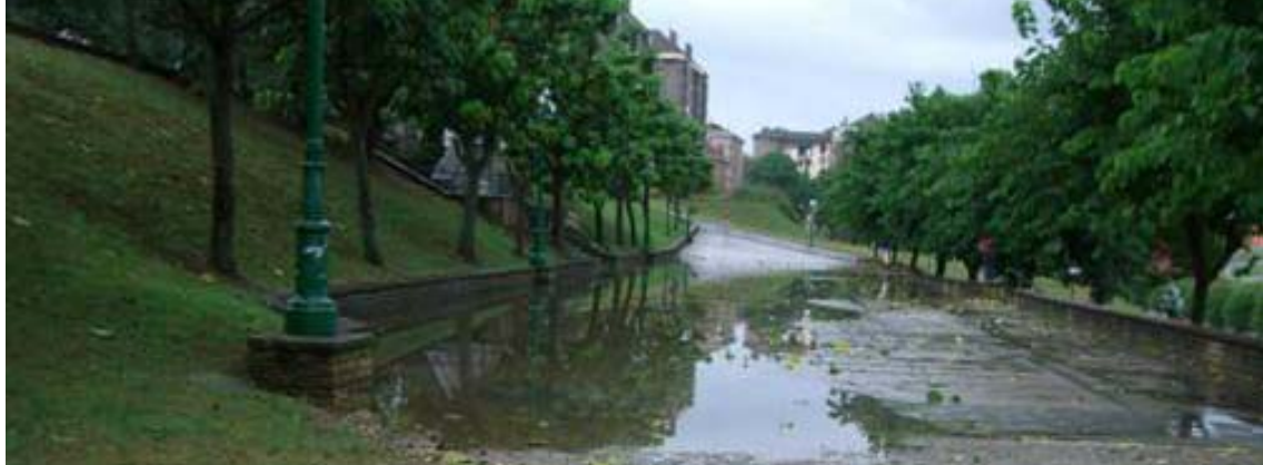
Figura I-1. Superficie impermeable con un deficiente diseño de drenaje.
