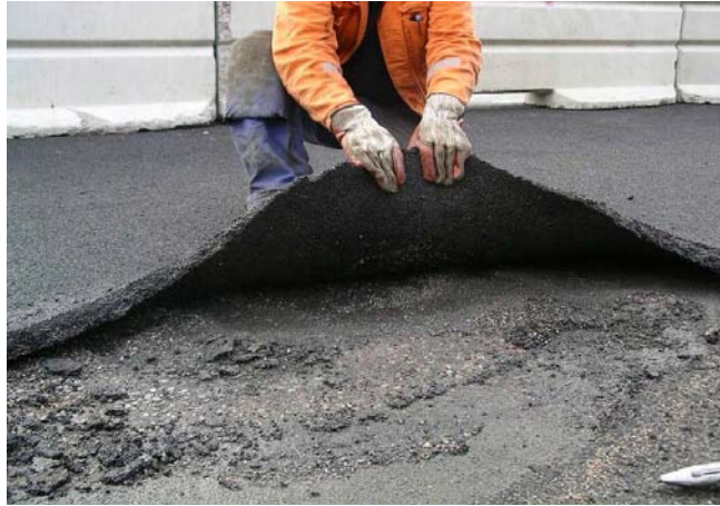
Fig.2.16 Detalle de la falta de adherencia entre capas [Ref. 31]
