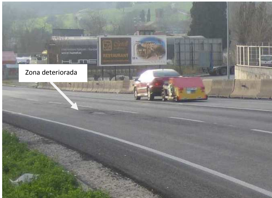
Fig. 3.32 Detalle del deterioro superficial en el tramo T4, en la mezcla BMPN+2%.
