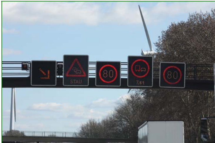
Figura n°4: Sistema de gestión variable del tráfico en una autopista. En la señal de "cambio de carril" puede verse un radar de velocidad
