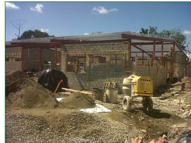
Fabricación de hormigón a pie de tajo para vigas y columnas de amarre
