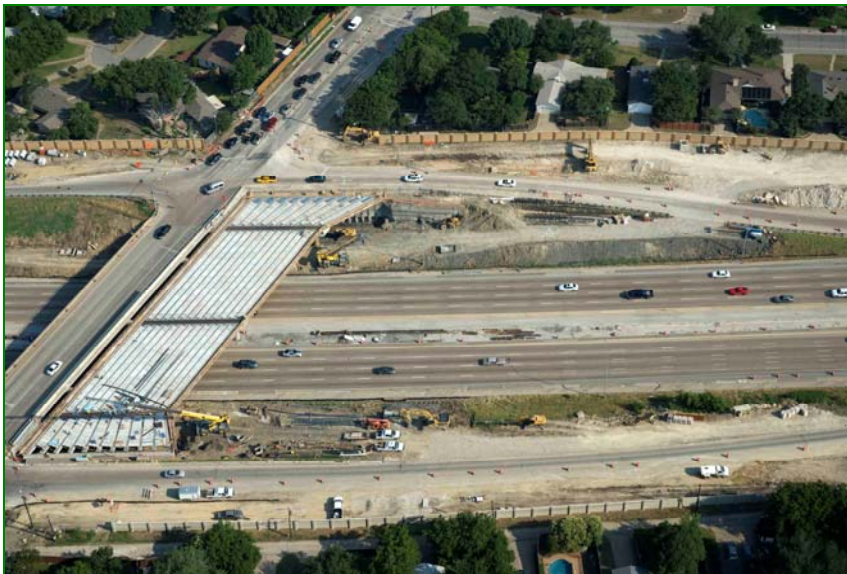
LBJ Express: Imagen de parte de las obras (duplicación de puente) en la actualidad.
