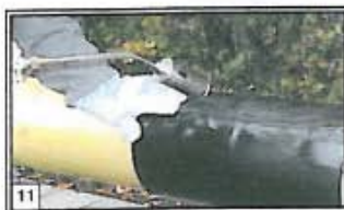
5 Calentar el lado exterior del parche de cierre colocada y presionar con el guante hasta que el pegamento derretido salga por los lados. Eventualmente pasar con un rodillo sobre toda la superficie del parche de cierre.
