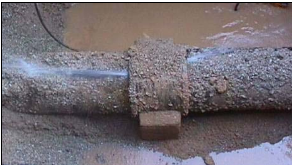
Fig. 7 Avería en una junta entre tubos
