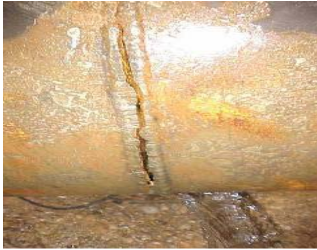
Fig. 69 Rotura de una soldadura circular.
