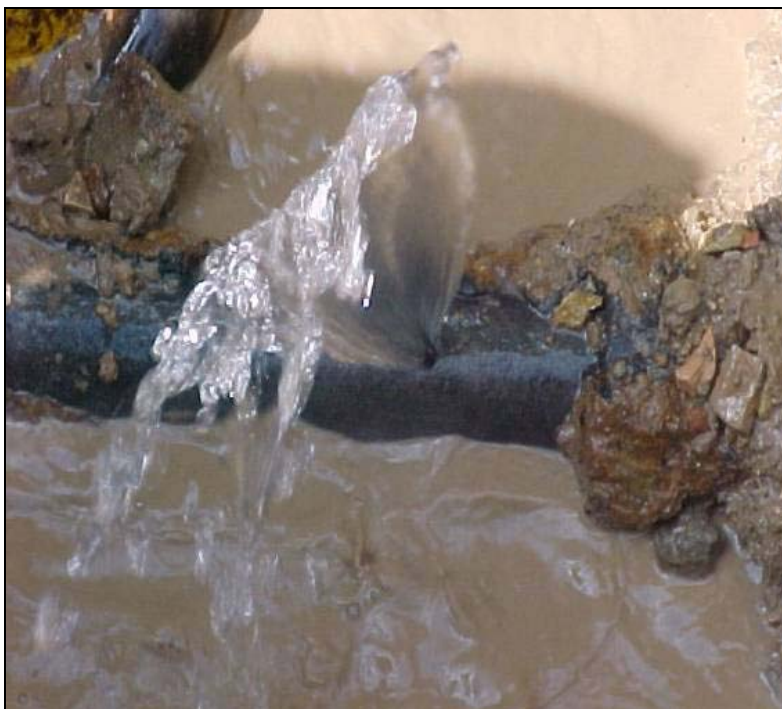
Fig. 6 Avería en una tubería
