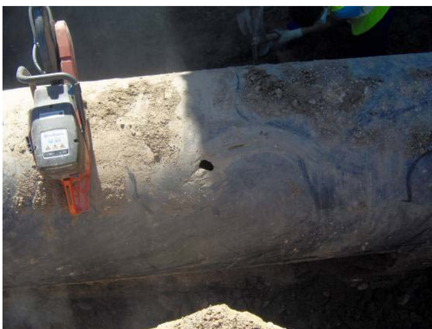
Fig. 30 Picotazo en tubería de fundición dúctil.
