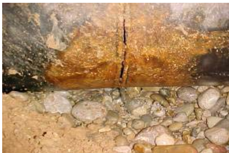
Fig. 64 Rotura de una soldadura circular en la unión de tuberías.
