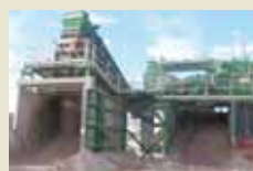
Tolva de salida de áridos
