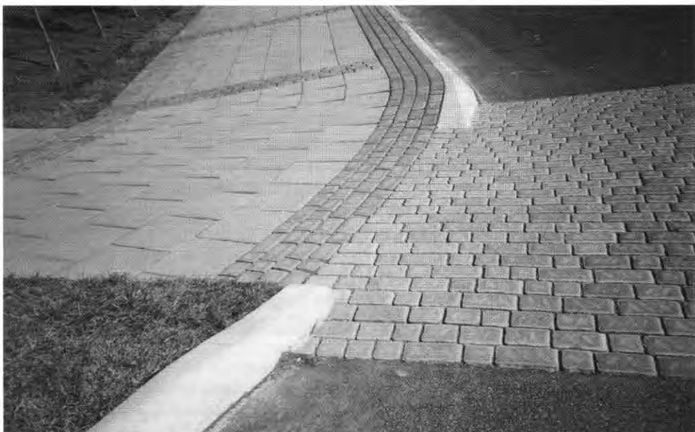
Foto 2: Detalle de vado de resalte
