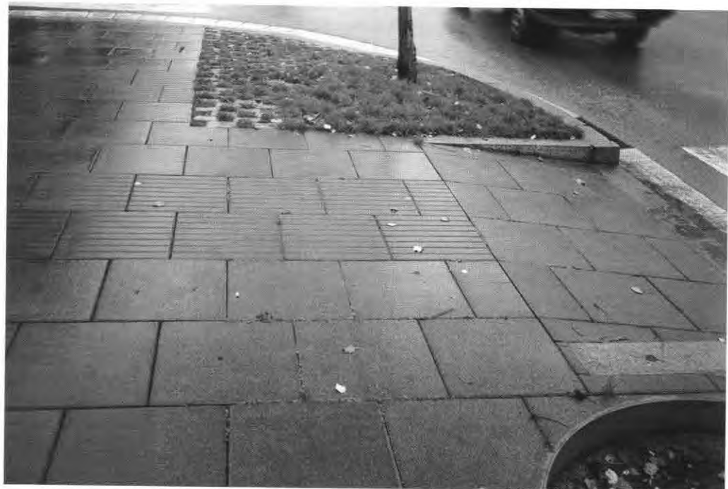
Foto 1: Franja señaladora central de un vado. La falta de contraste de color con el pavimento del itinerario peatonal en que se ubica, no favorece a las personas con resto visual
