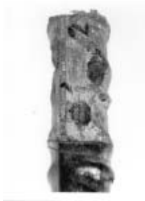
Figura A.8 Ataque localizado debido a los cloruros.
