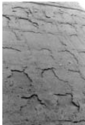
Figura A.5 Mapa de fisuras siguiendo la cuadrícula de armado, debido a la carbonatación del recubrimiento.
