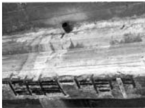
Figura A.6 Saltado del recubrimiento debido a corrosión generalizada por carbonatación.
