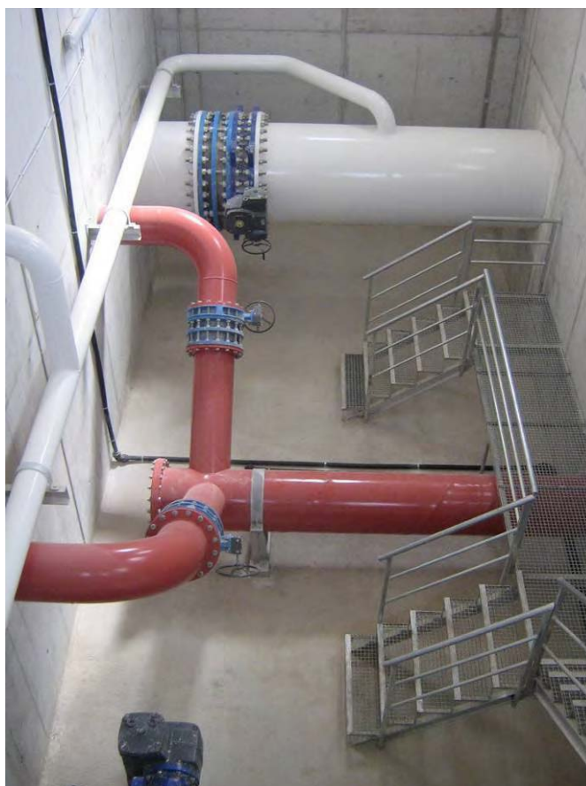
CASETA DE SALIDA CON TUBERÍAS DE SALIDA Y DESAGÜES DE FONDO
