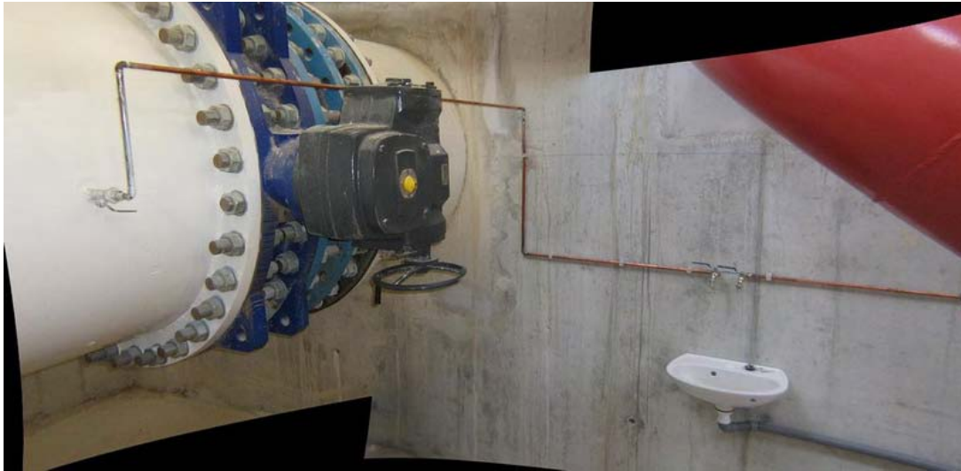
TOMA DE MUESTRAS EN TUBERÍA DE SALIDA
