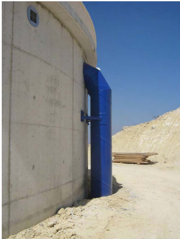
TUBERÍA DE ENTRADA DE AGUA
