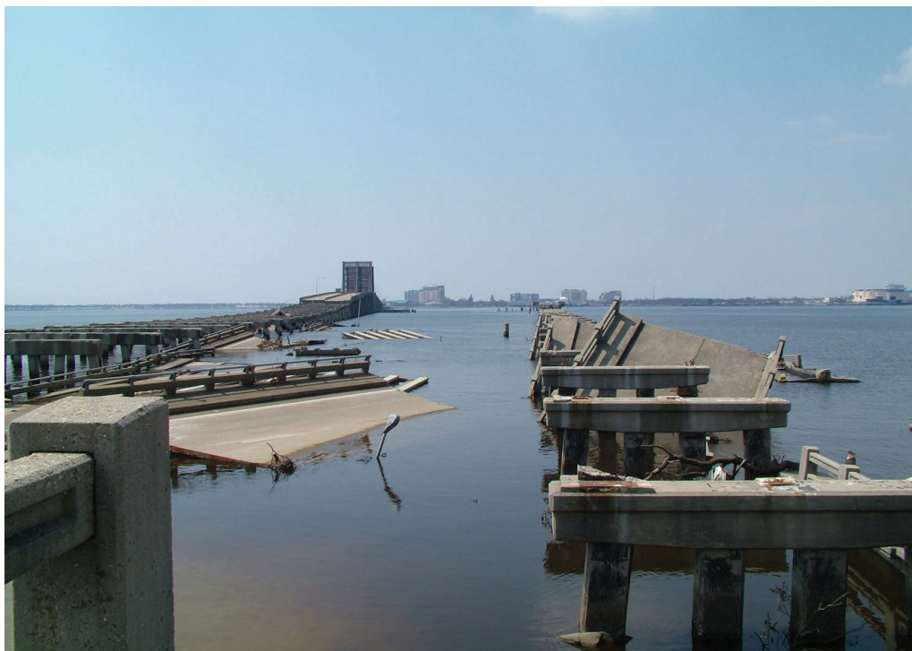
Ilustración 1 - El puente "Biloxi Bay Bridge" destruido por el huracán Katrina
