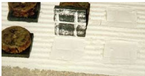
Rotura adhesiva baldosa/adhesivo (ANFAPA) RA-B
