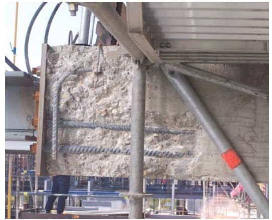
Figura 10.- Fallo en una placa de anclaje por mala ejecución.
