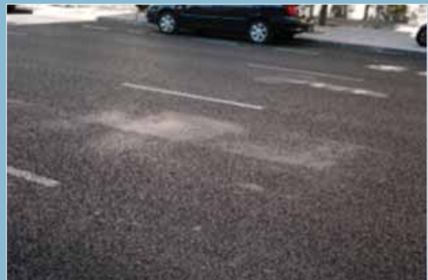
Exudaciones por exceso de riego de adherencia.
